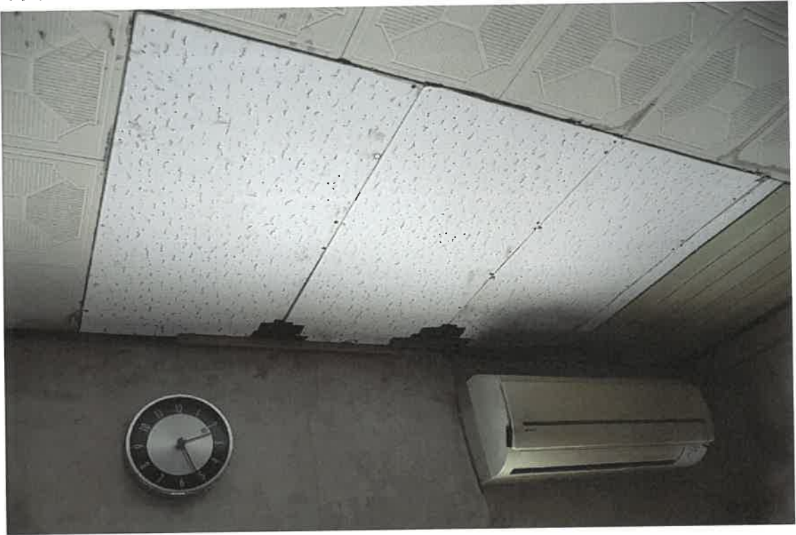
写真11 物件2主建物1階リビングダイニング天井部分の損傷箇所
