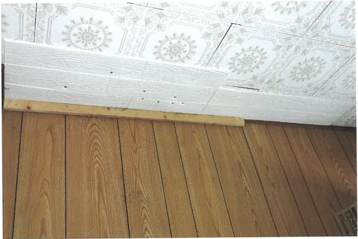
物件2主建物2階納戸天井部分の損傷箇所
