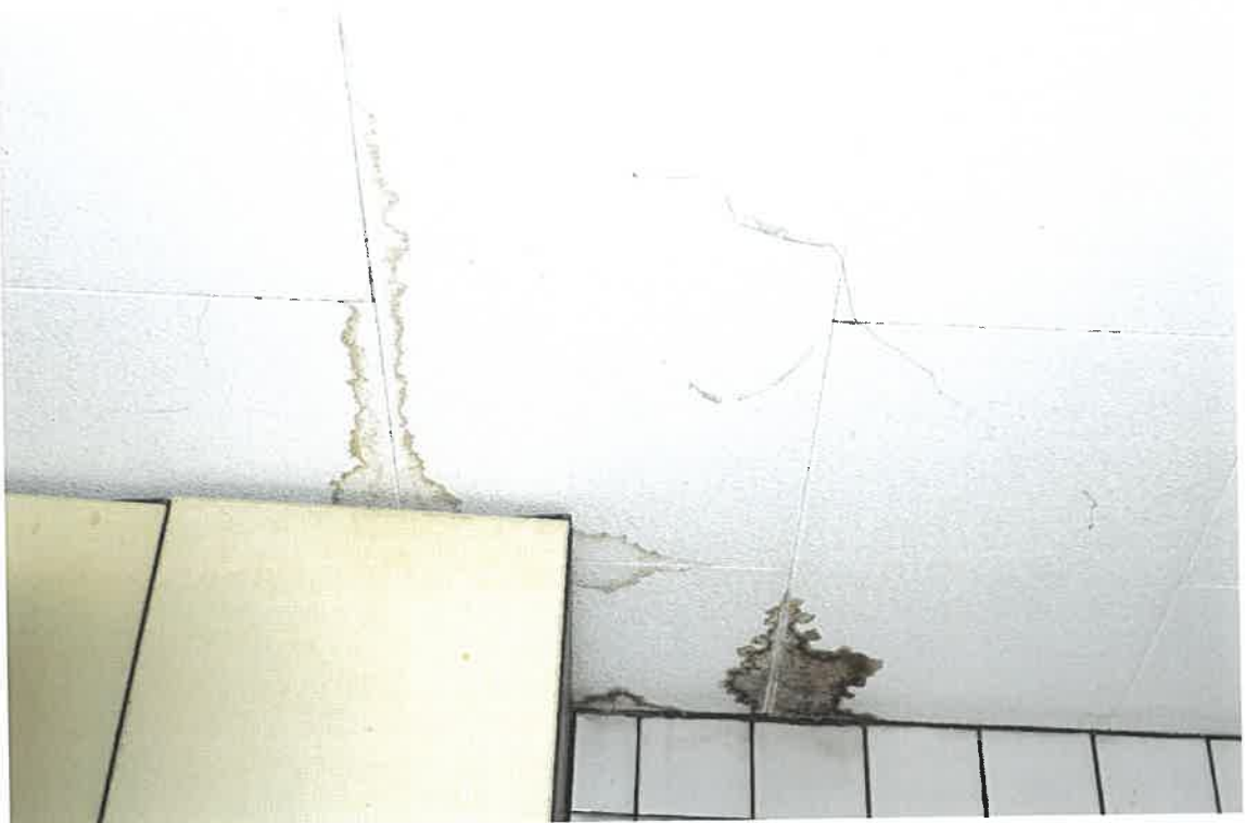
写真12 物件2主建物2階廊下天井部分の損傷箇所
