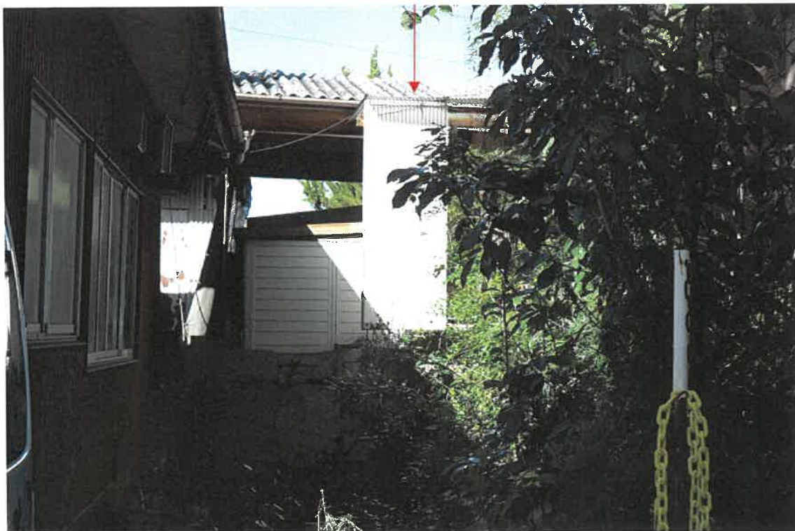
写真 2 2 物件 1 土地西側隣地（1 8 6 2 番 3）上の底部分が物件 1 土地上に越境しているものと思料する状況
