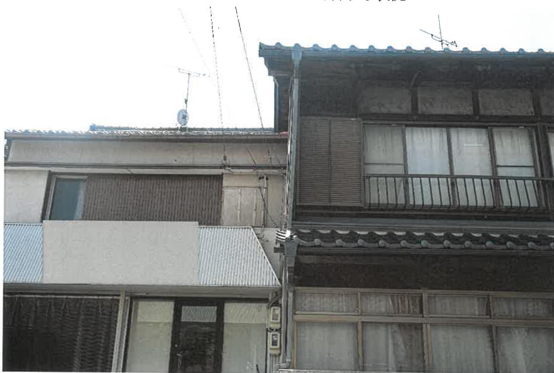
物件 3 主建物の屋根及び底の一部が物件 1 土地の南側隣地（地番 3 6 番）上に越境しているものと思料する状況
