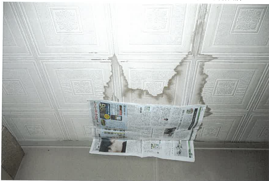
物件 3 主建物 1 階キッチンの天井部分の損傷箇所
