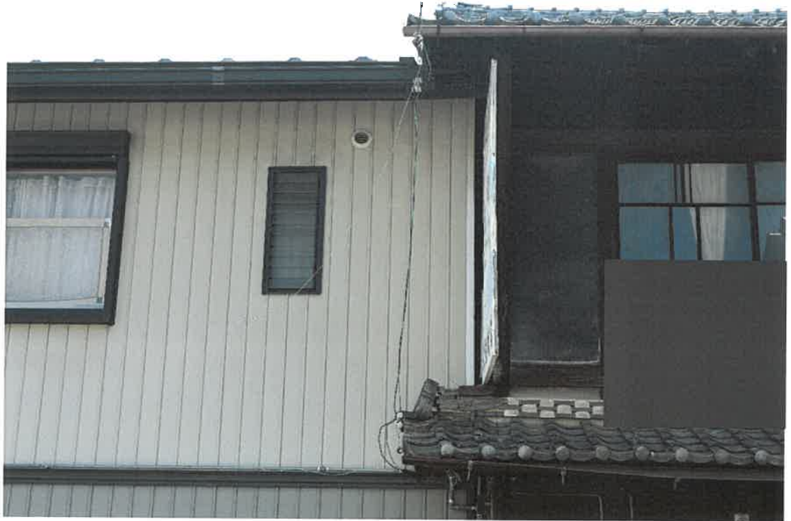
写真2 1 物件1 土地の西側隣地（地番4 6 番）上に建っている建物（家屋番号4 6 番）の屋根及び庇の一部分が物件1 土地上に越境している可能性があるものと思料する
