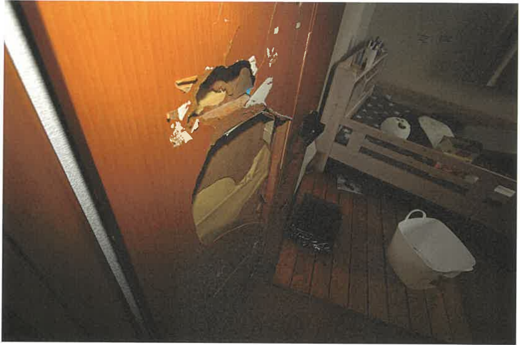
物件 4 建物 2 階室内 扉に穴が開いていて破れている。
