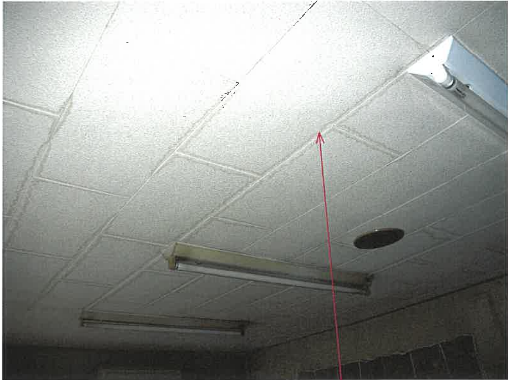
前同建物の1階事務所内（天井の染み）
