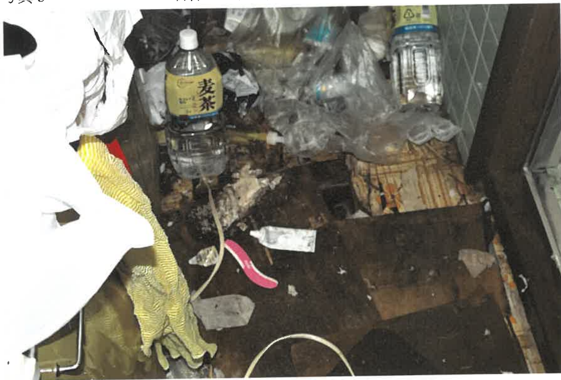
物件 2 建物 1 階廊下部分の損傷状況
