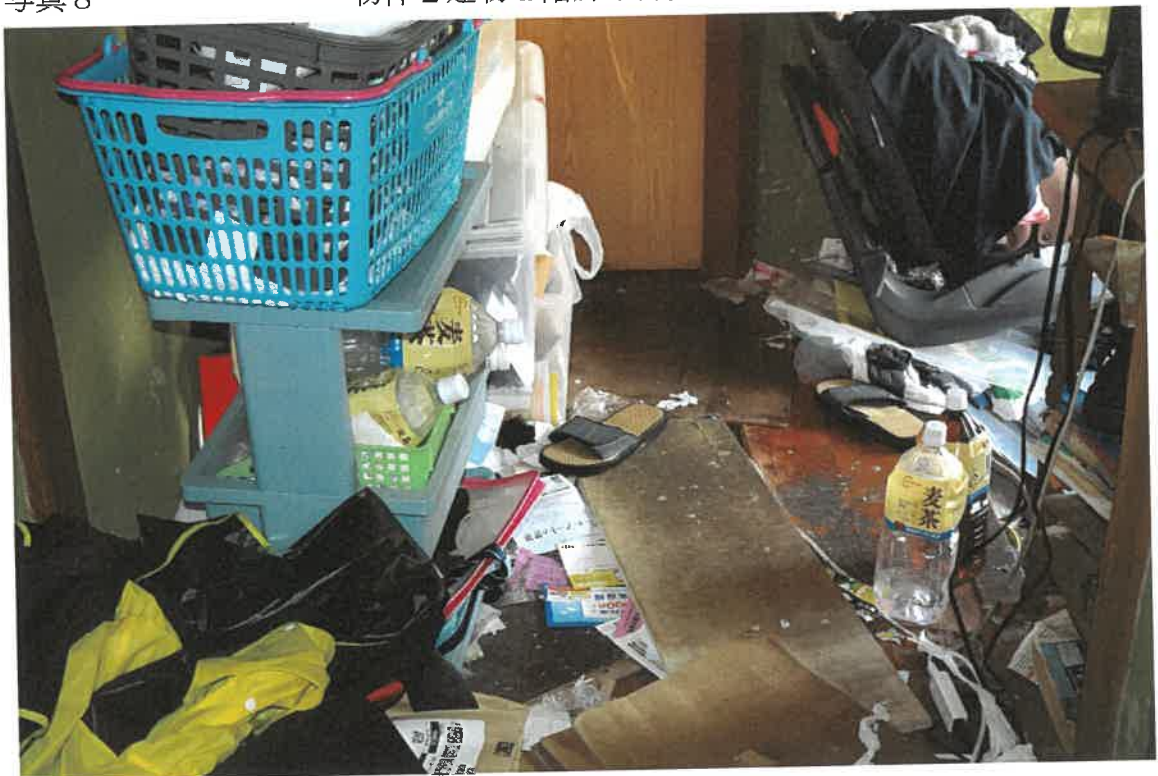
物件 2 建物 1 階廊下部分の損傷状況
