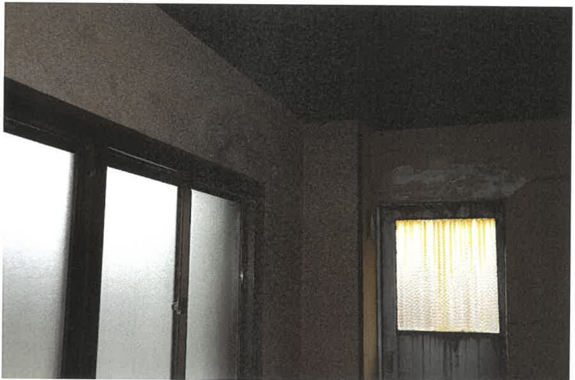
写真3 4 物件6建物2階廊下部分の壁の損傷箇所
