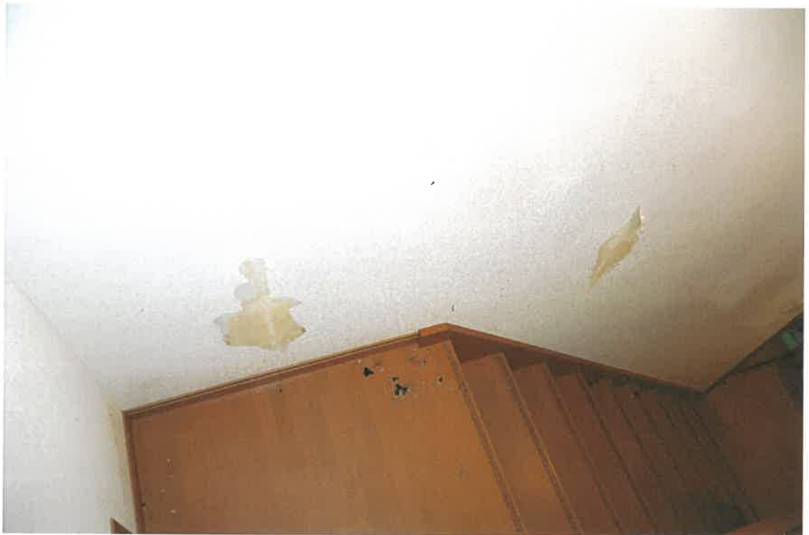
物件 2 建物階段壁の損傷箇所
