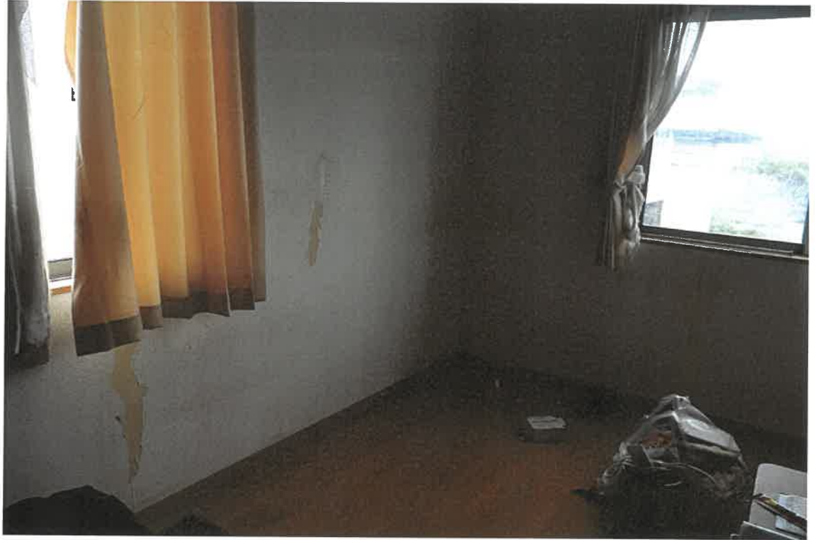
物件 2 建物 2 階北側洋室壁の損傷箇所
