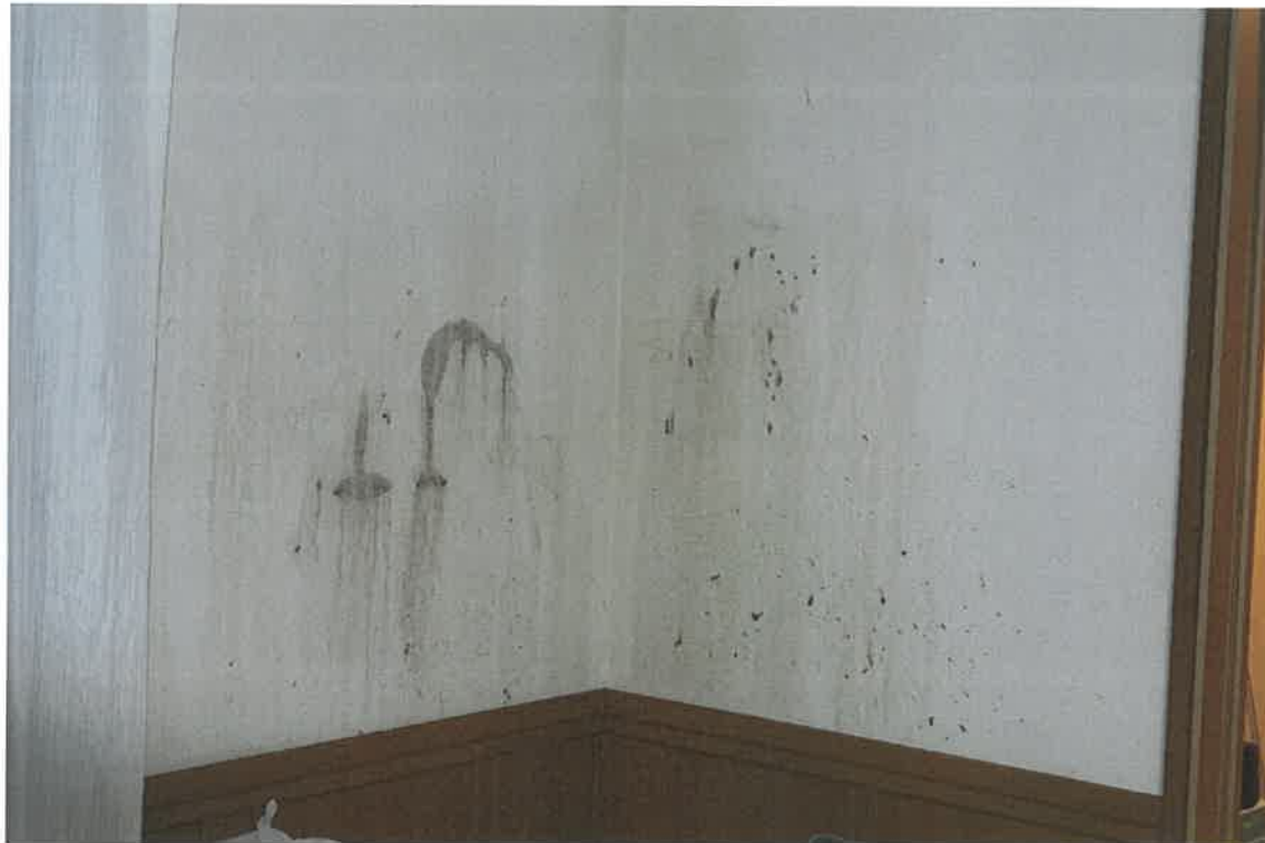
物件 2 建物 1 階 L D K 壁の損傷箇所
