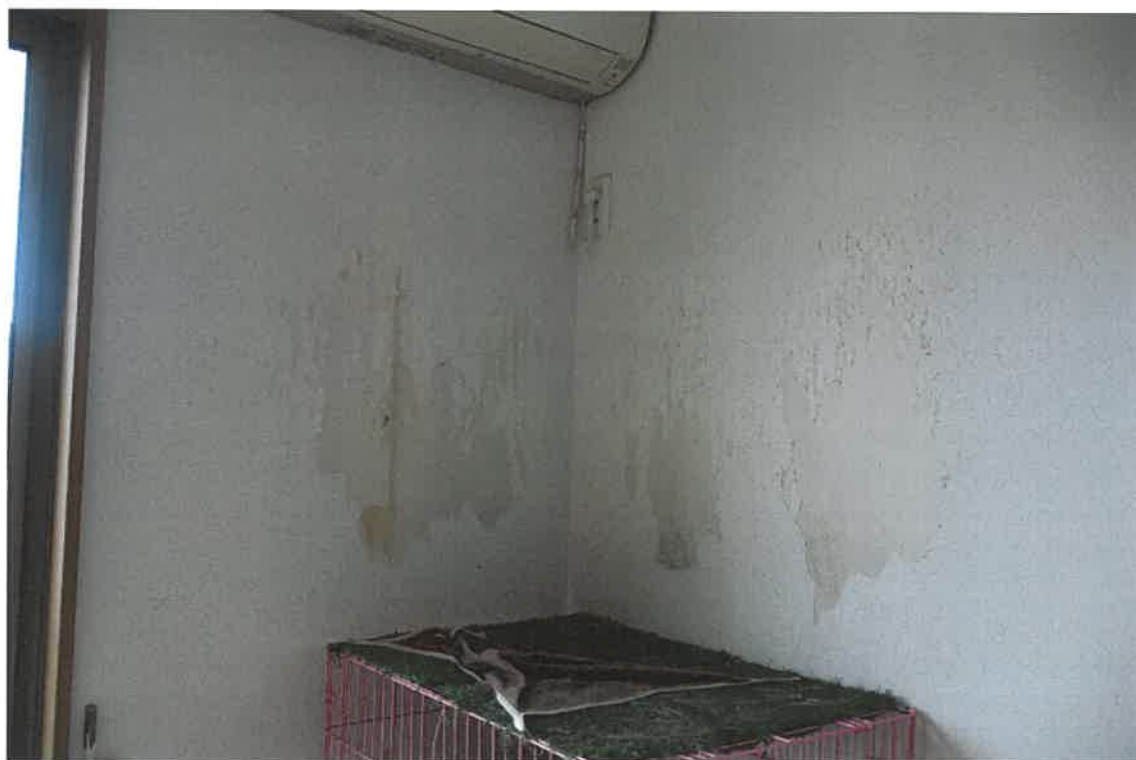
物件 2 建物 2 階南西側洋室壁の損傷箇所
