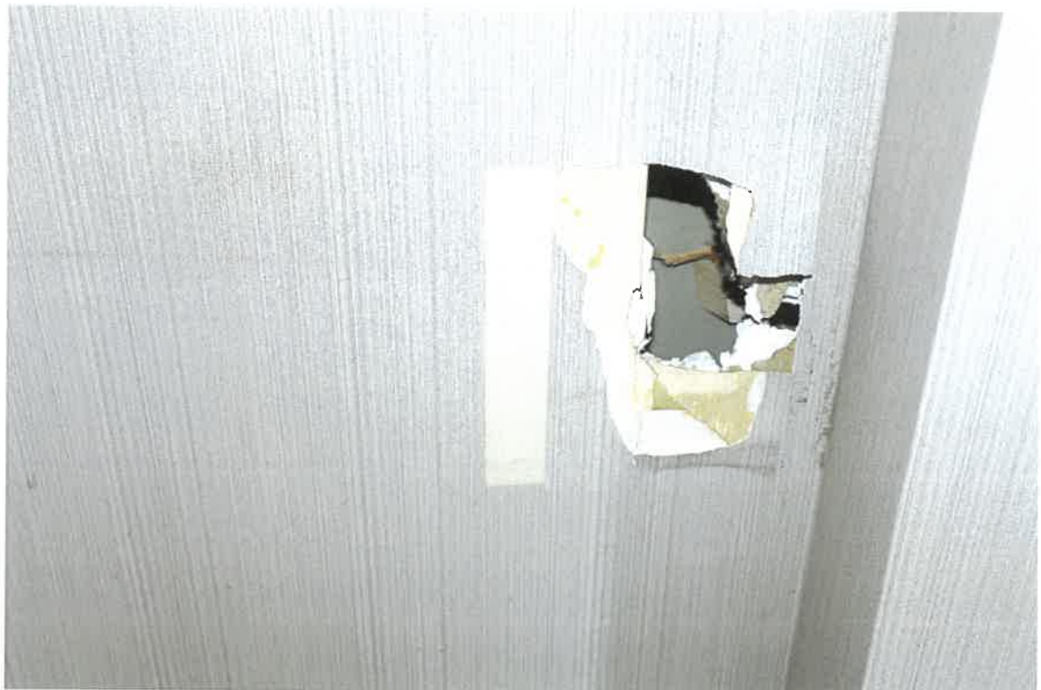
物件2建物2階階段壁の損傷箇所
