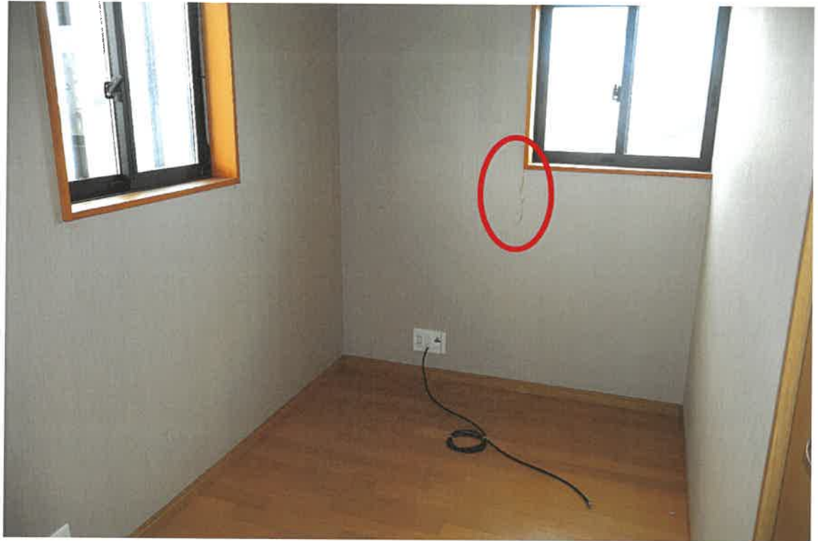
物件2建物2階北側洋室の壁の損傷箇所
