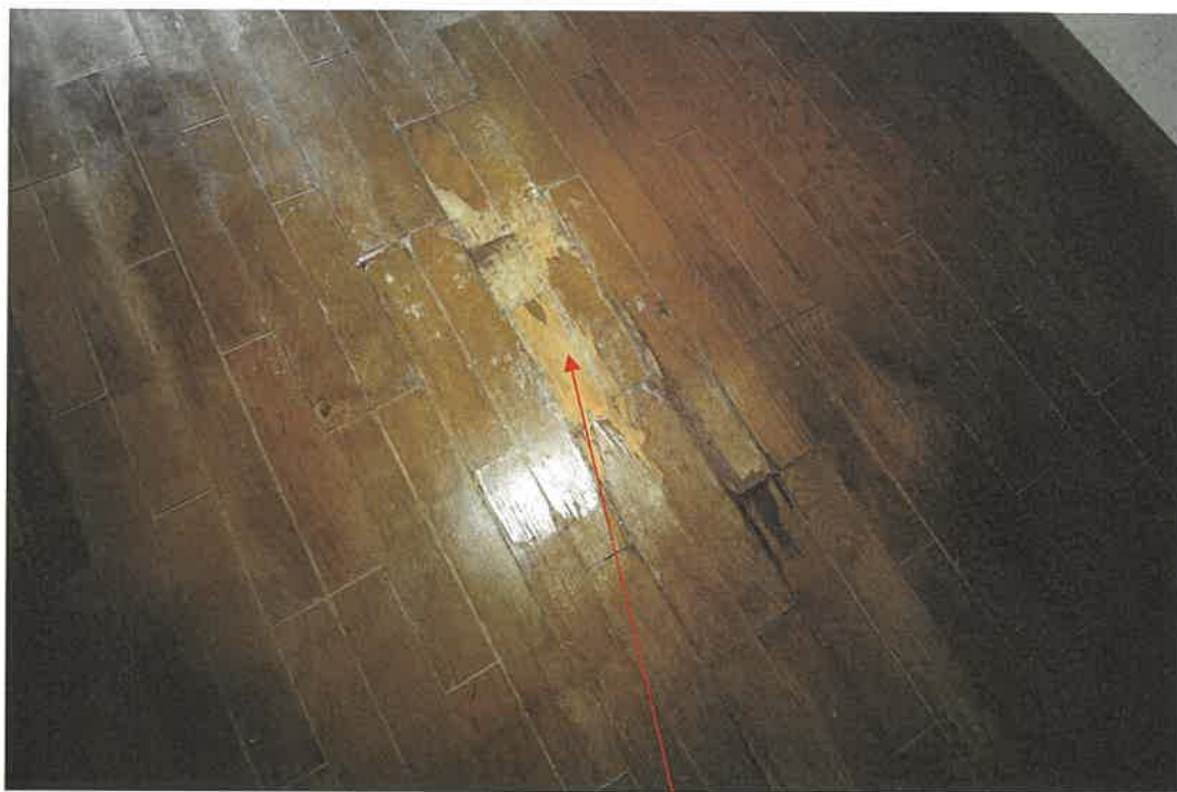
専有部分の建物 室内 床がめくれている
