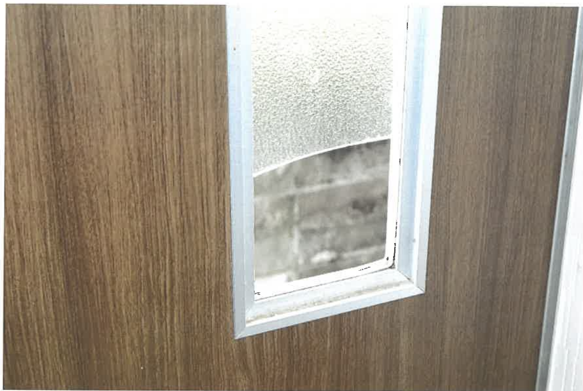
写真1 1 物件2建物1階キッチンリビング扉のガラスが割れている状況
