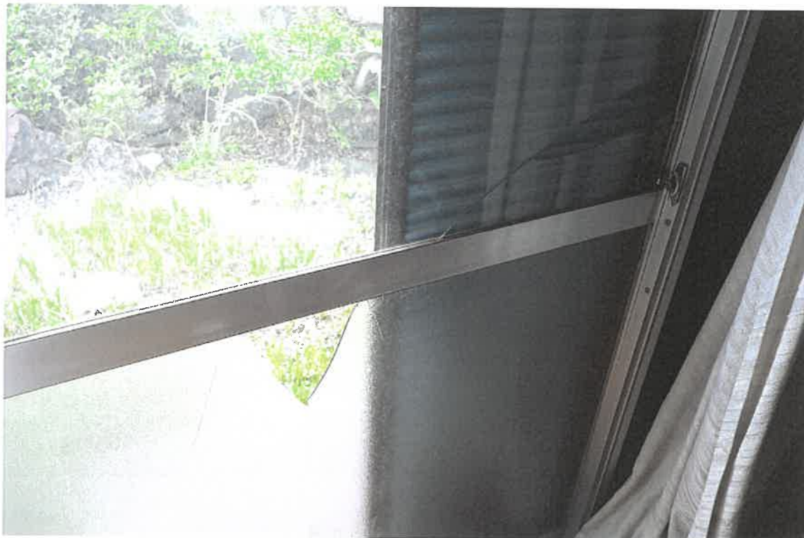
物件 2 建物 1 階南東側洋室の掃出し窓が割れている状況
