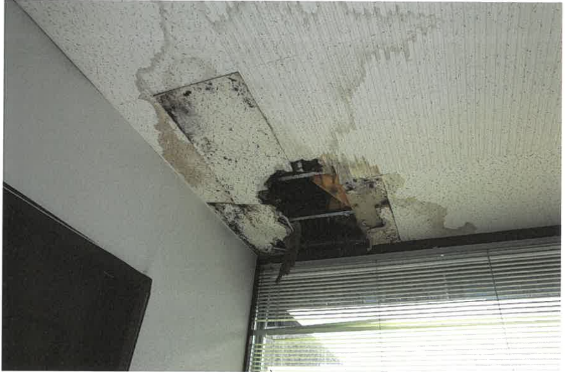
物件 1 3 建物 2 階の会議室天井部分の損傷状況
