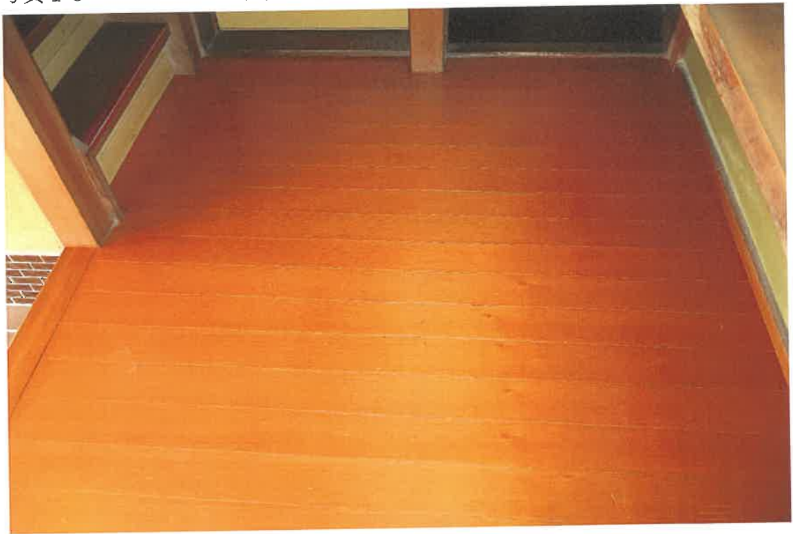
物件 2 主建物 1 階廊下の不安定な箇所
