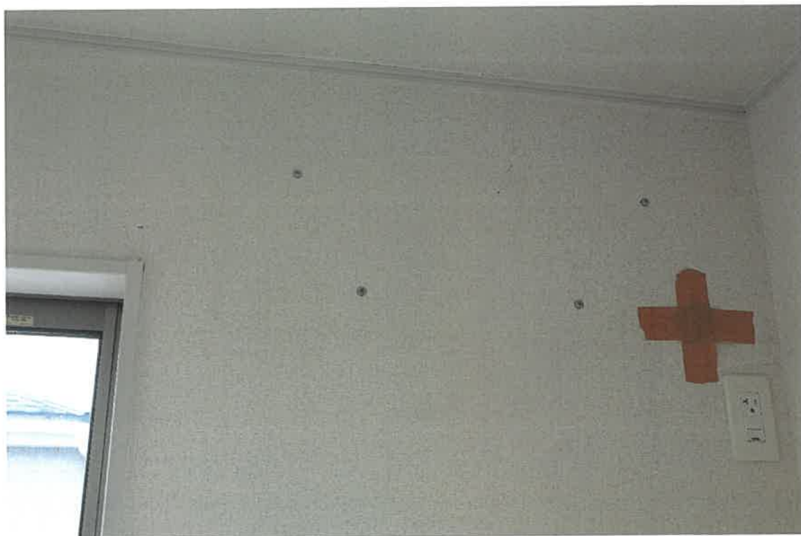
物件 2 建物 2 階西側洋室の壁の損傷箇所
