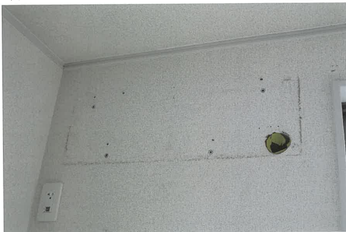
物件 2 建物 2 階東側洋室の壁の損傷箇所
