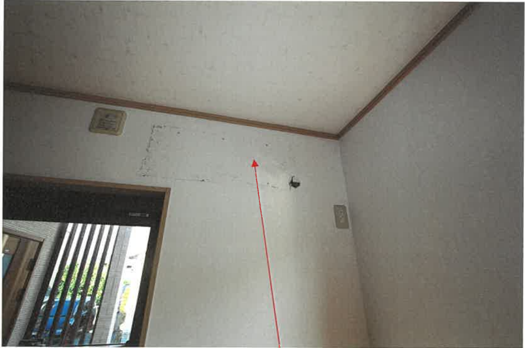
物件 2 建物 1 階室内 エアコンを外した痕
