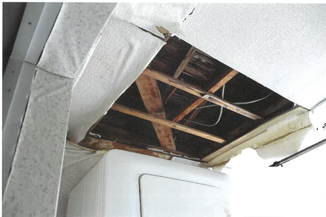
物件 2 建物 2階ランドリー室天井の損傷箇所
