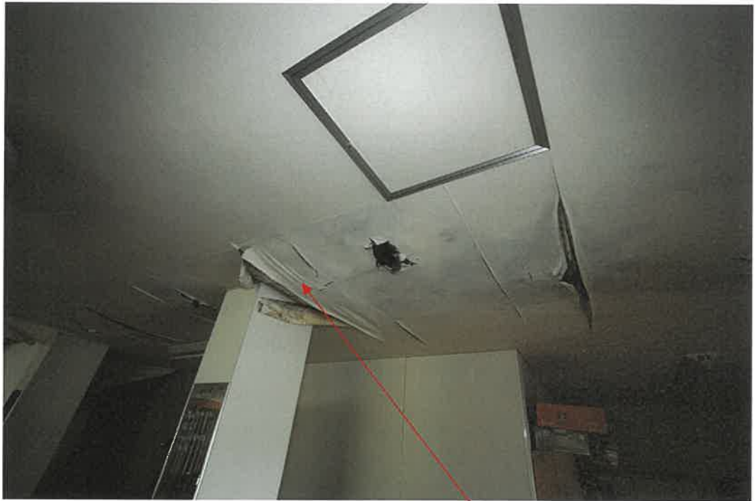
物件 2 主建物 2 階室内 雨漏り痕
