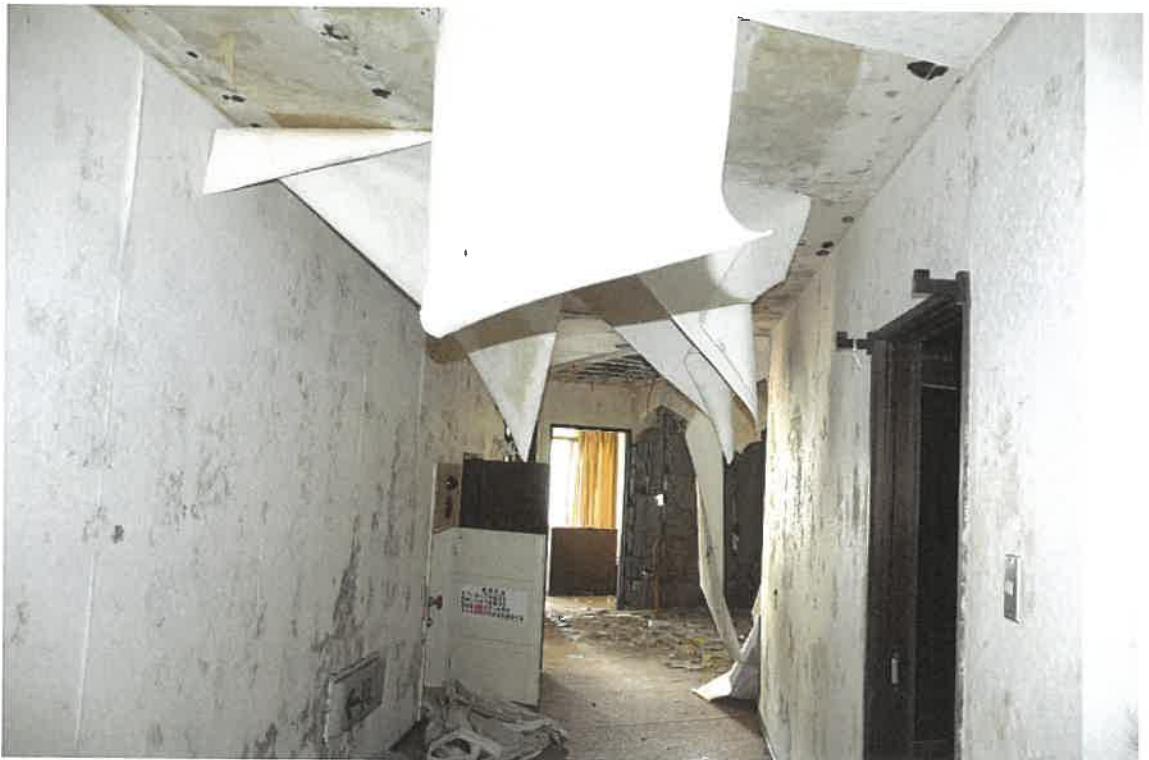
物件 3 主建物 1 階廊下部分の損傷状況
