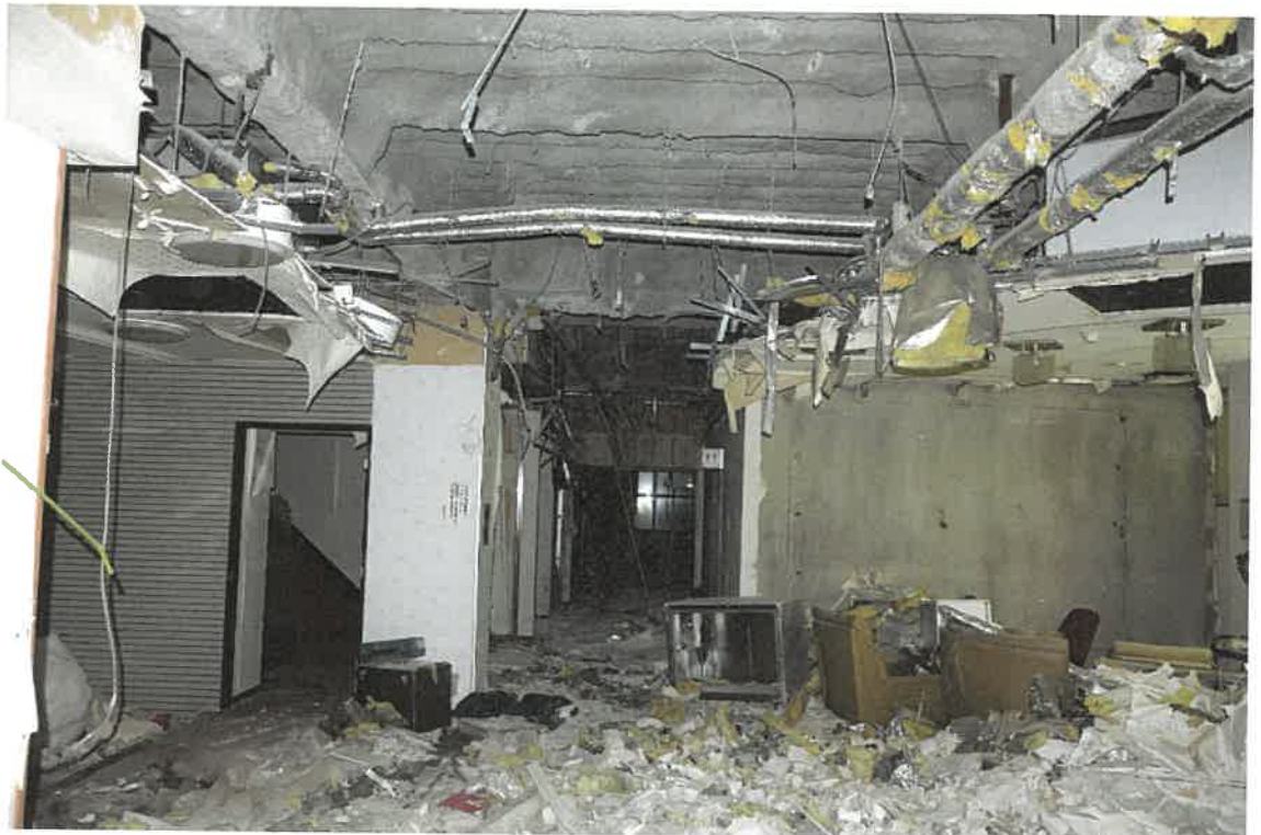
物件 3 主建物 1 階廊下部分の損傷状況
