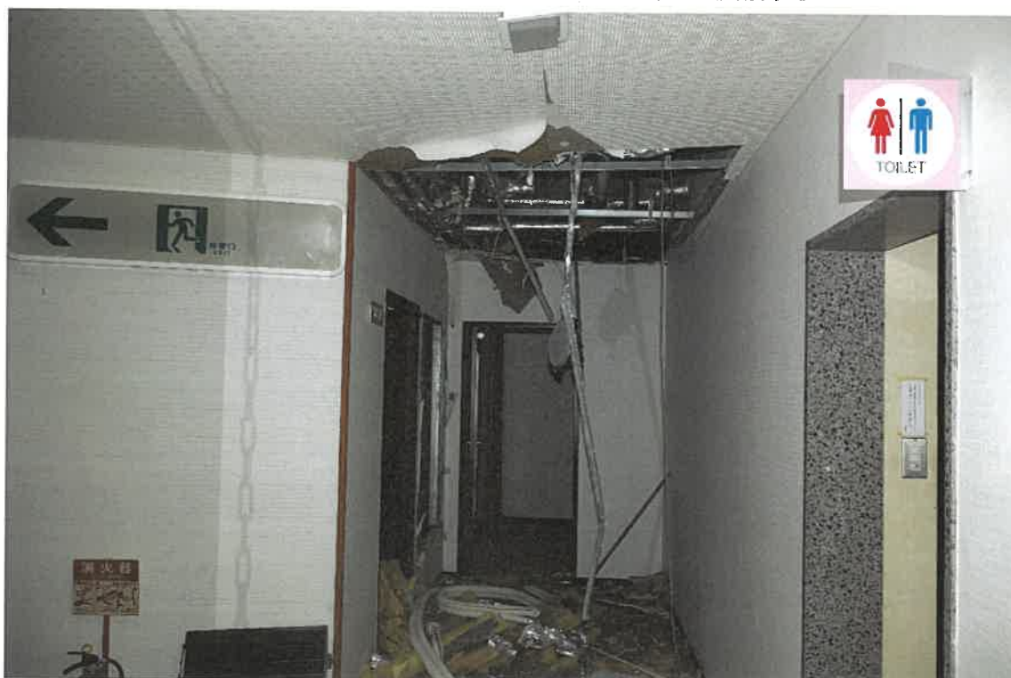
物件 3 主建物 2 階廊下部分の損傷状況
