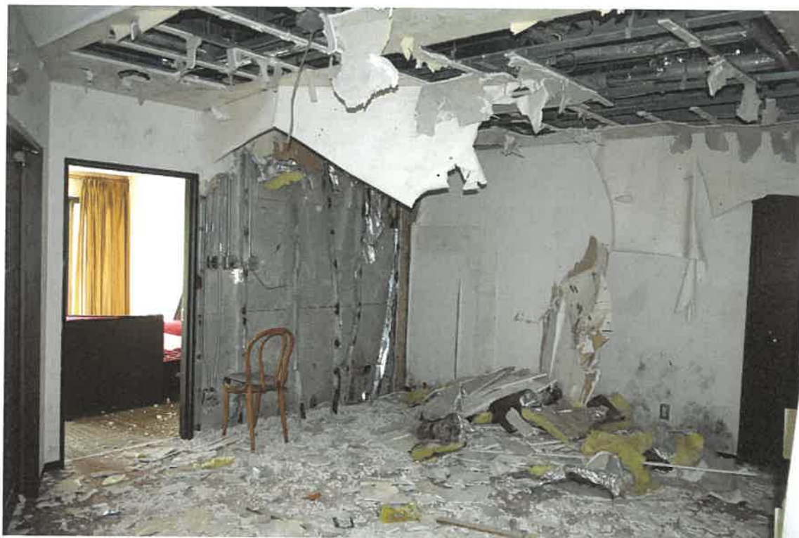
物件 3 主建物 1 階廊下部分の損傷状況
