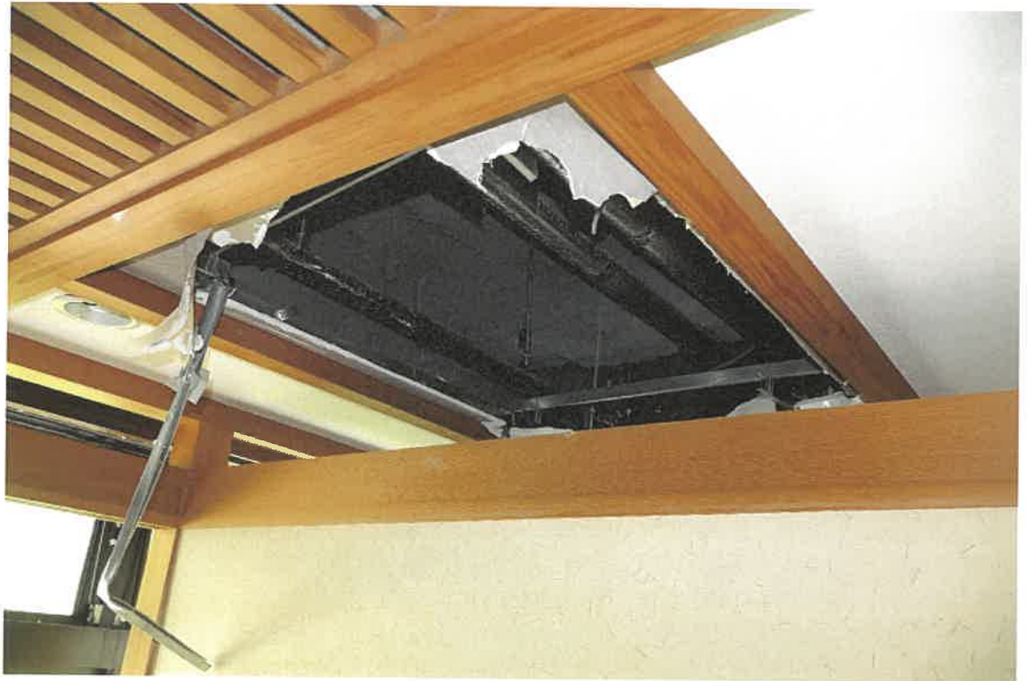
物件 3 主建物 2 階お食事処の天井部分の損傷状況
