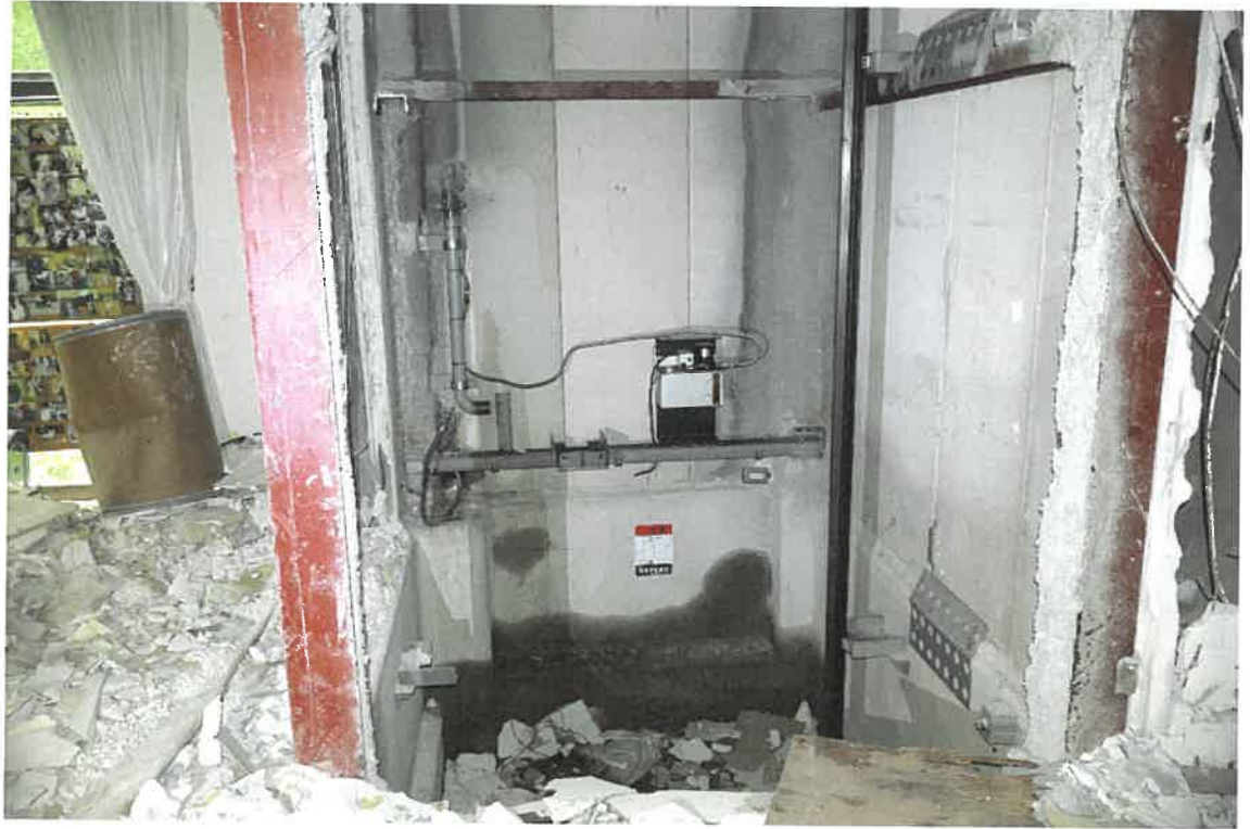
物件 3 主建物 1 階エレベーター部分の損傷状況
