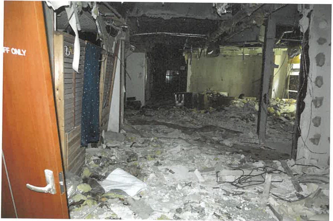
物件 3 主建物 1 階廊下部分の損傷状況
