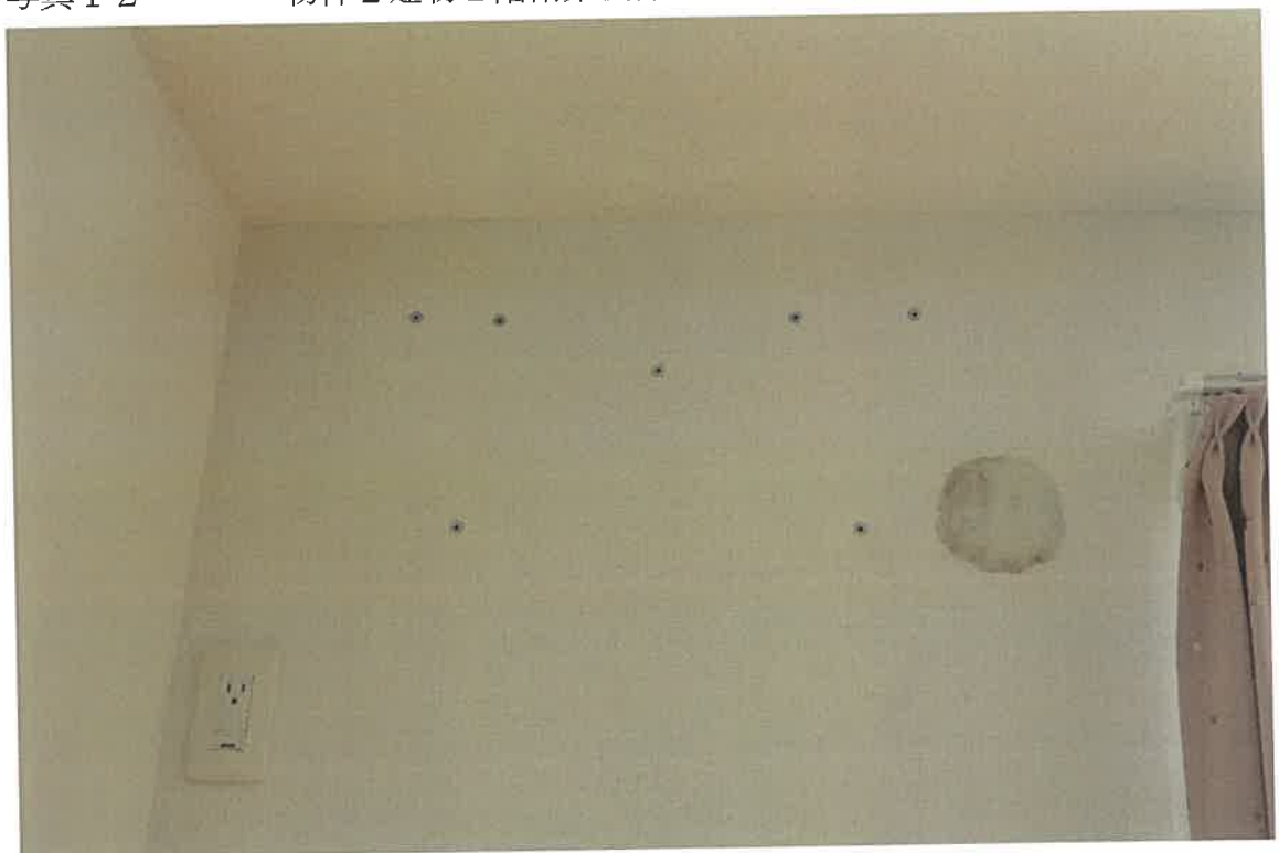
物件 2 建物 2 階南東側洋室内の壁の損傷箇所
