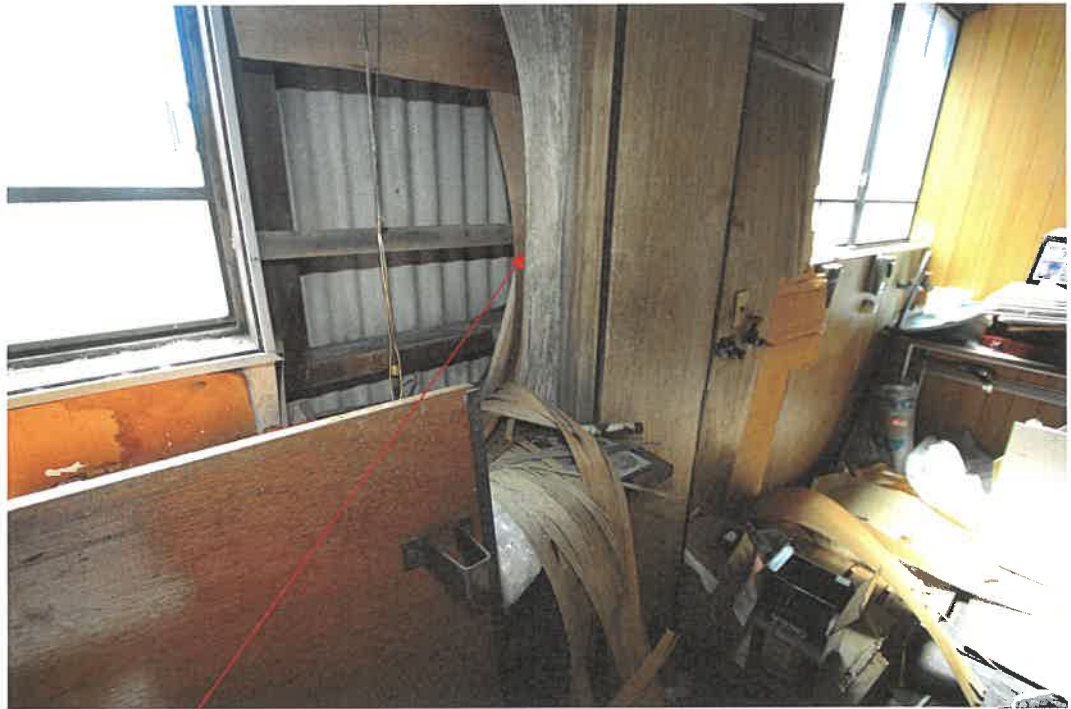
壁がめくれている
