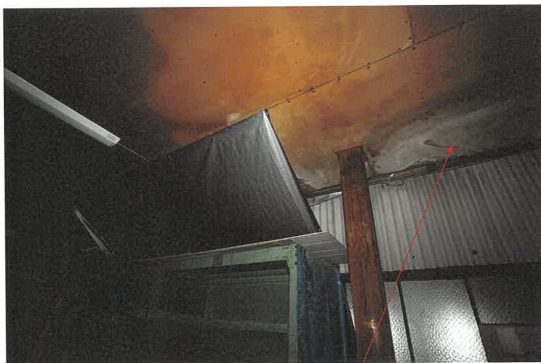
物件 5 附属建物 1 室内 雨漏り痕
