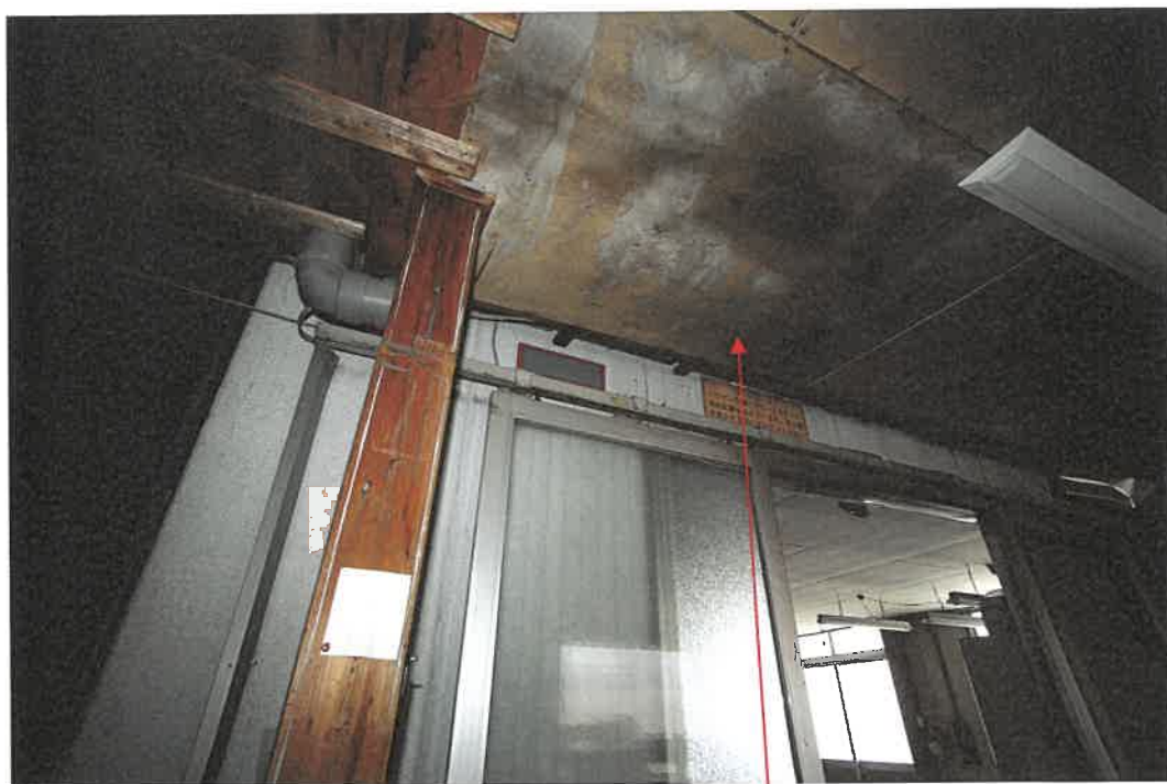
物件 5 附属建物 1 室内 雨漏り痕
