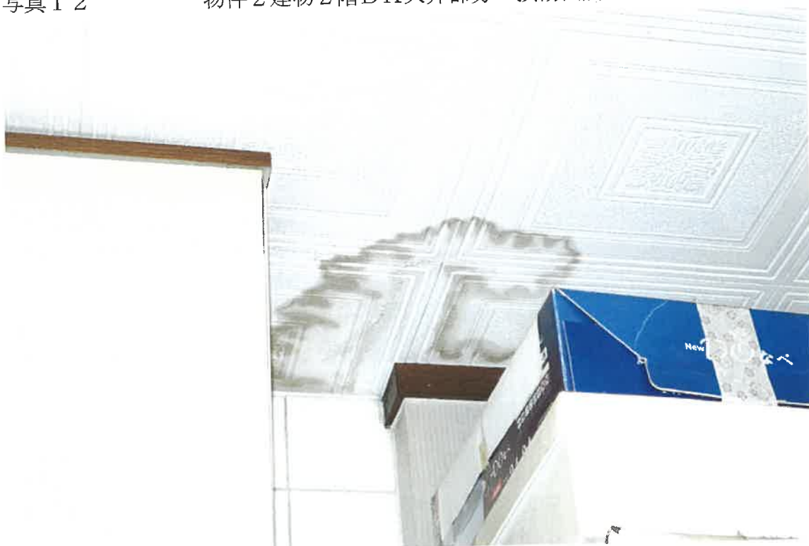
物件 2 建物 2 階DK天井部分の損傷箇所
