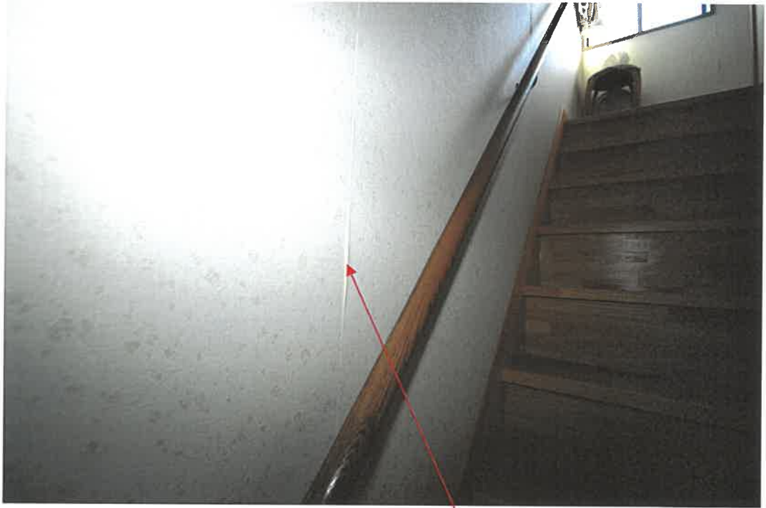
物件 1 建物 1 階から 2 階への階段 クロスの剥がれ
