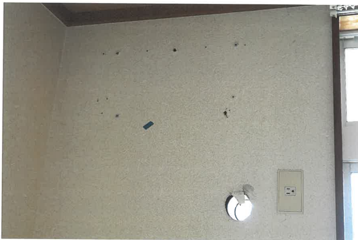
物件 2 建物 2 0 1 号室南東側洋室の壁の損傷箇所
