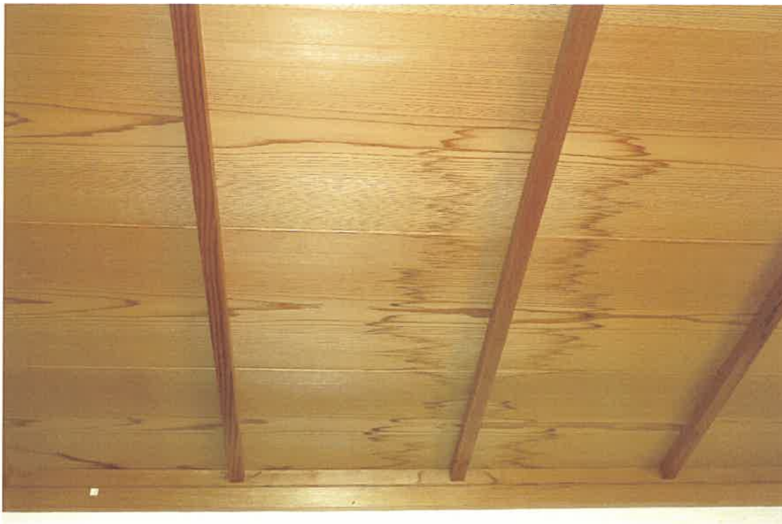
物件 2 建物 1 階南東側和室の天井部分の損傷箇所
