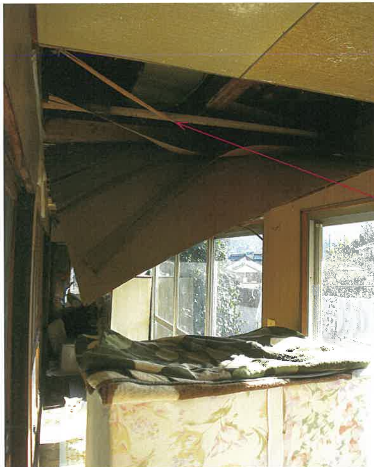
前同建物の縁側の 天井の損傷箇所
