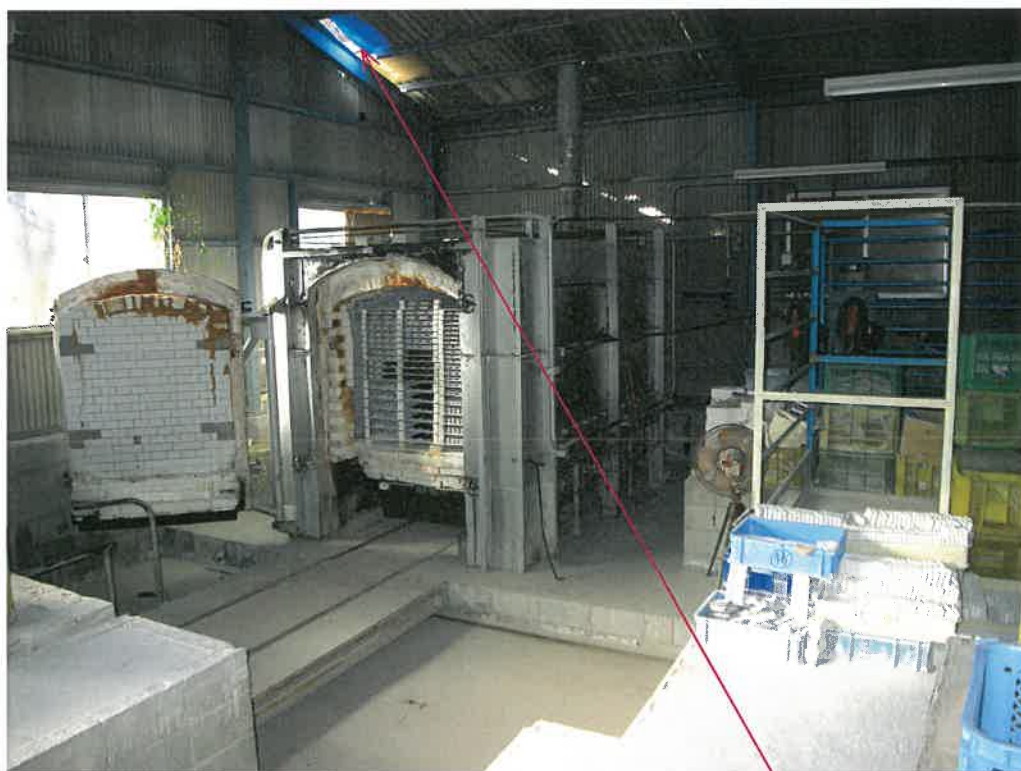
物件3 附属建物の陶磁器焼成用窯場内（屋根の隙間箇所）
