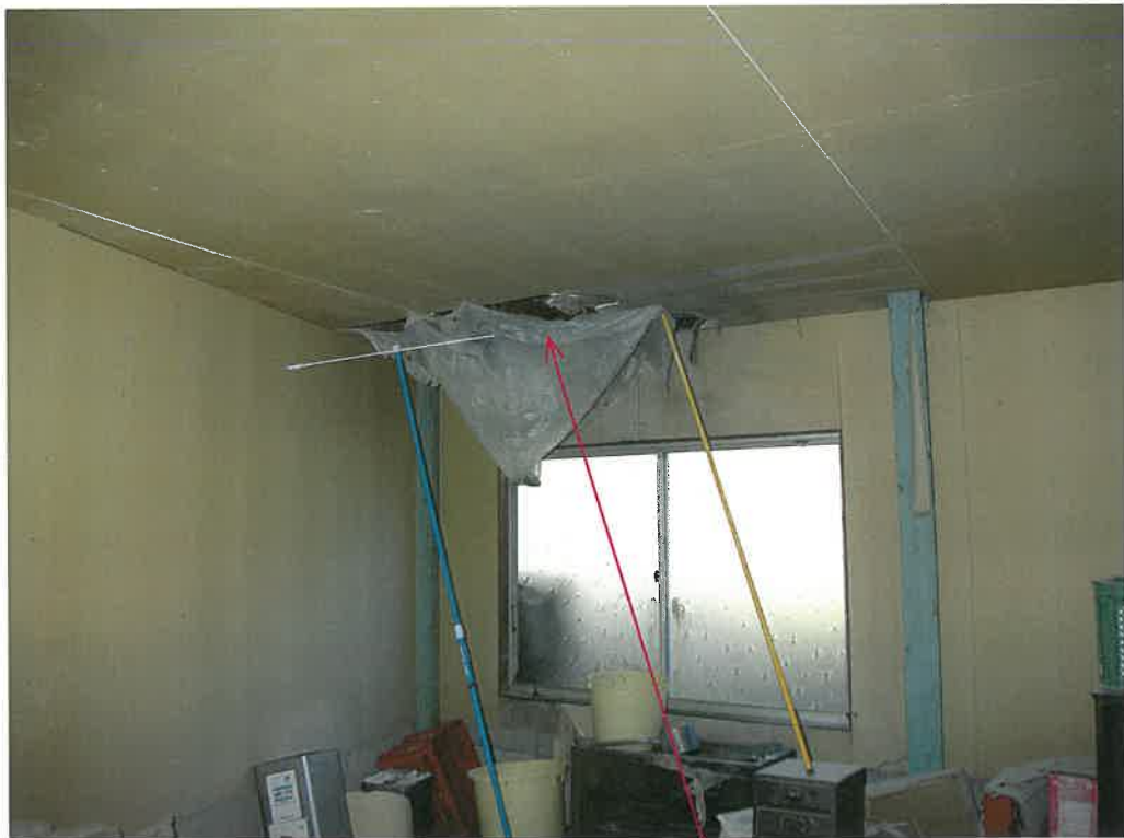
前同建物の作業場内（天井の損傷箇所）
