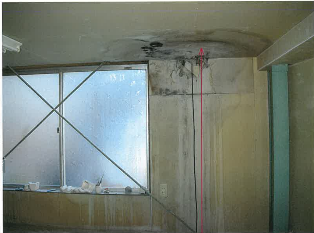
前同建物の作業場内（雨漏り箇所）
