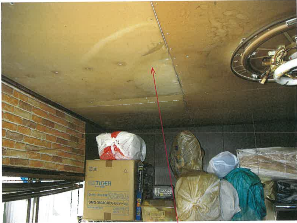
前同建物の室内（雨漏り箇所）
