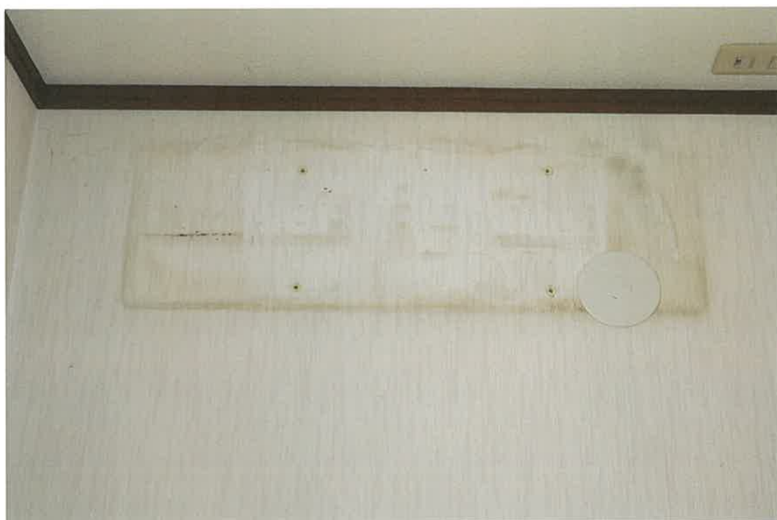
物件 2 建物 2 階南西側洋室の壁の損傷箇所
