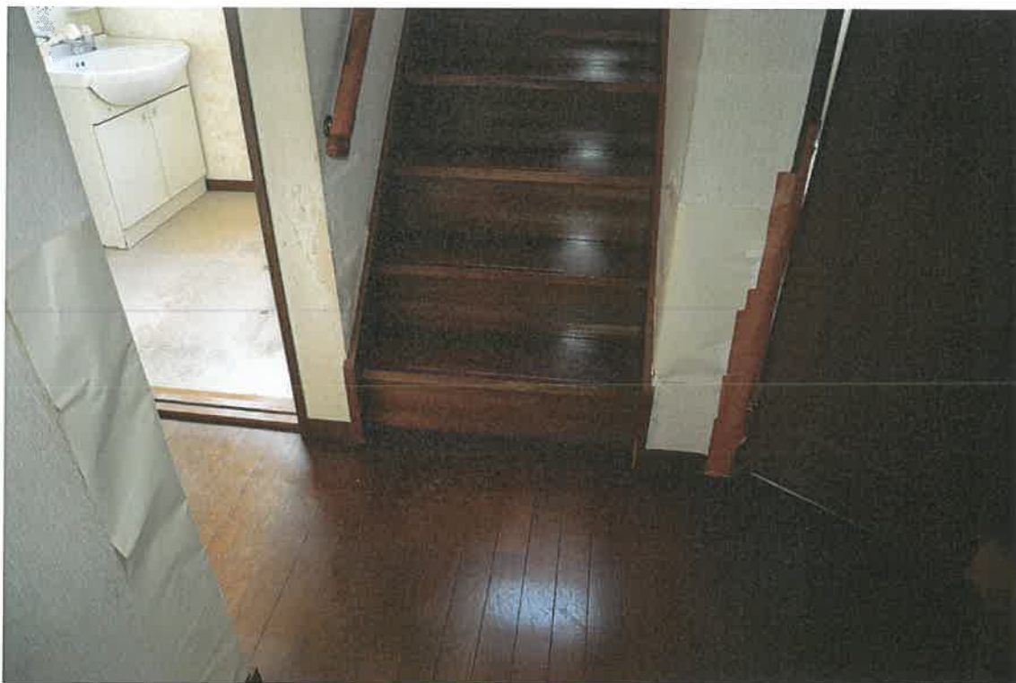
物件 2 建物 1 階廊下の壁の損傷箇所
