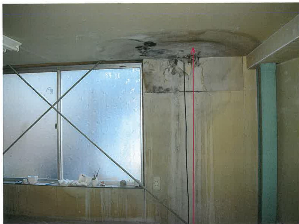
前同建物の作業場内（雨漏り箇所）
