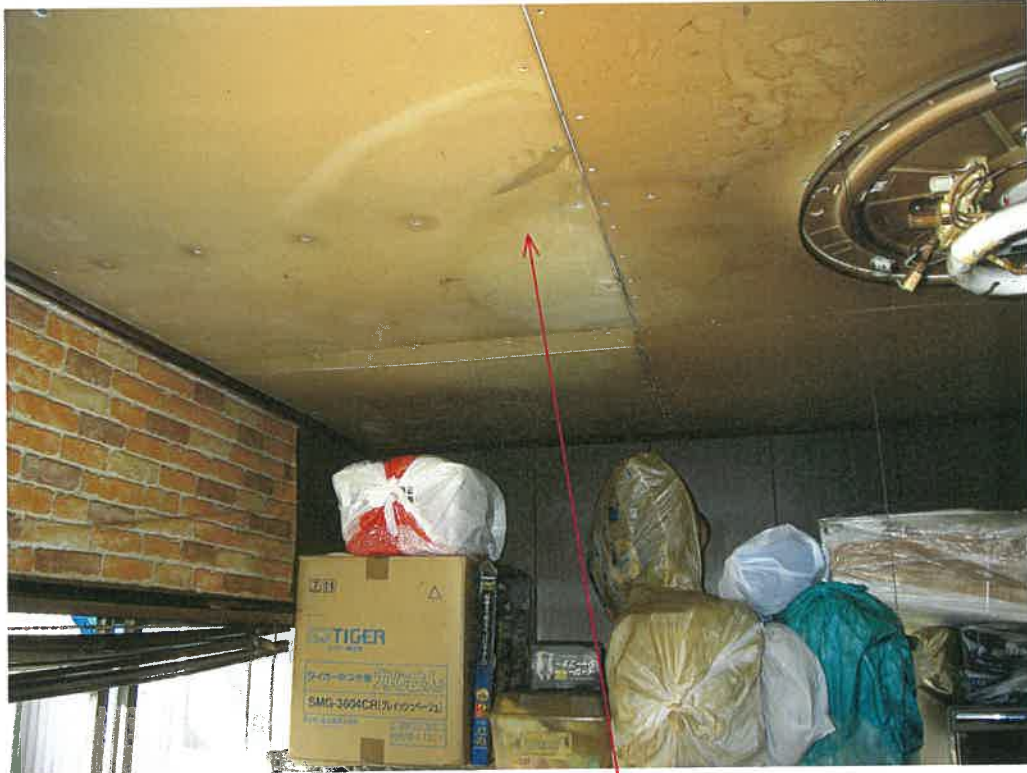
前同建物の室内（雨漏り箇所）
