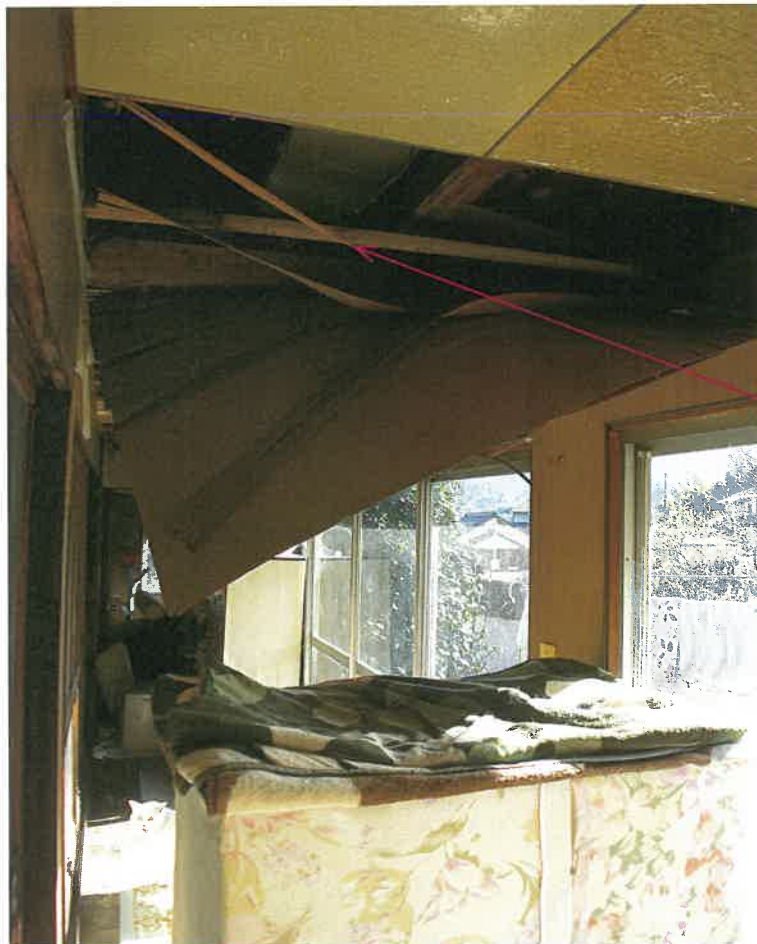
前同建物の縁側の 天井の損傷箇所
