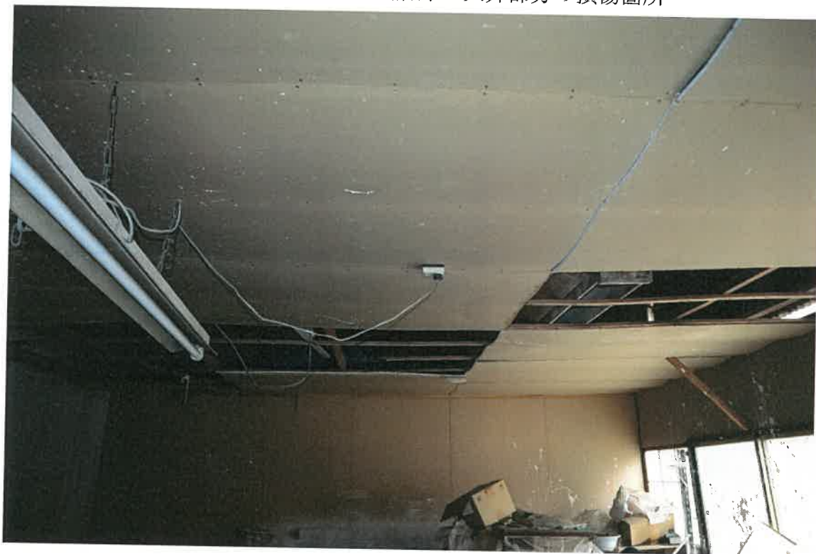
写真 2 1 物件 7 主建物の南西側倉庫の天井部分の損傷箇所
