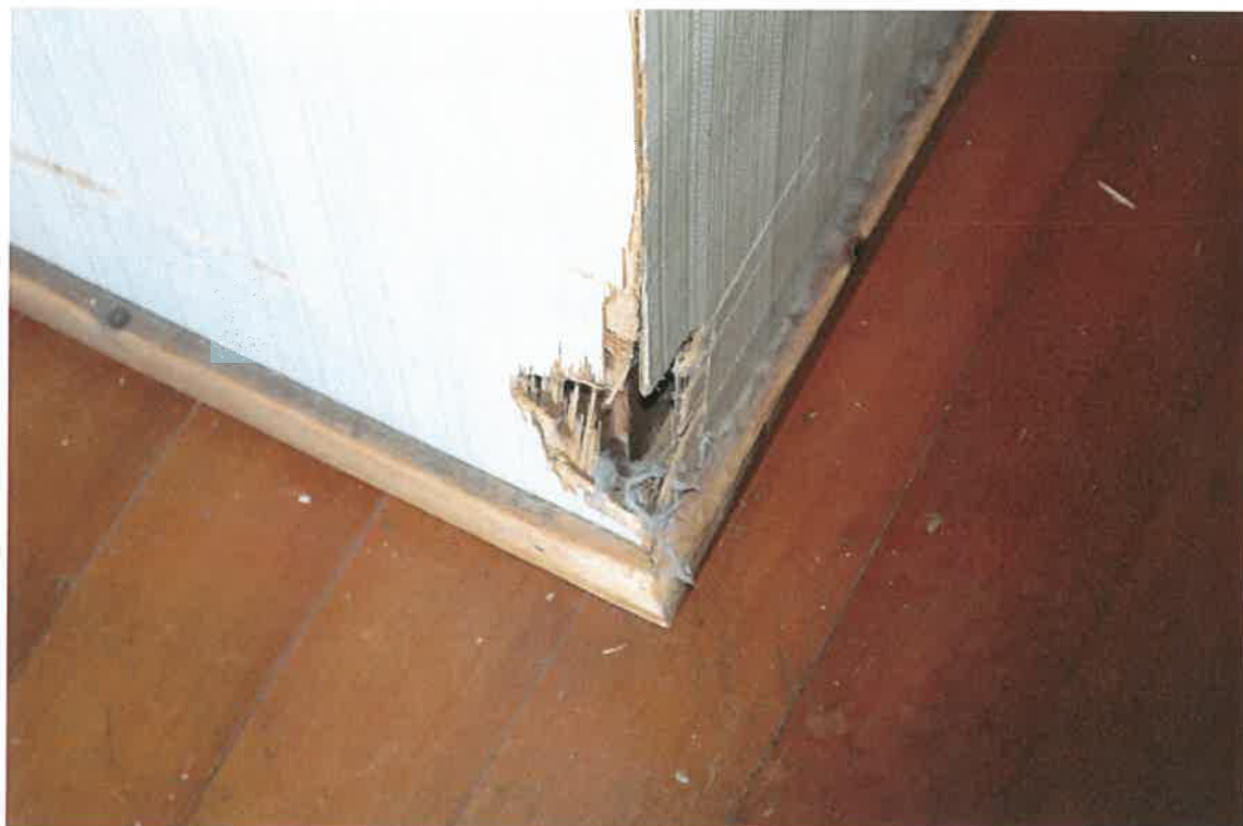
物件 7 附属建物 2 廊下の壁の損傷箇所
