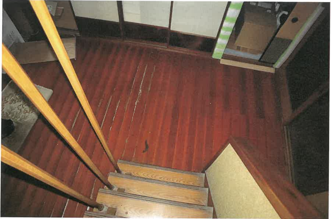
物件 8 建物 1 階廊下部分が不安定な箇所
