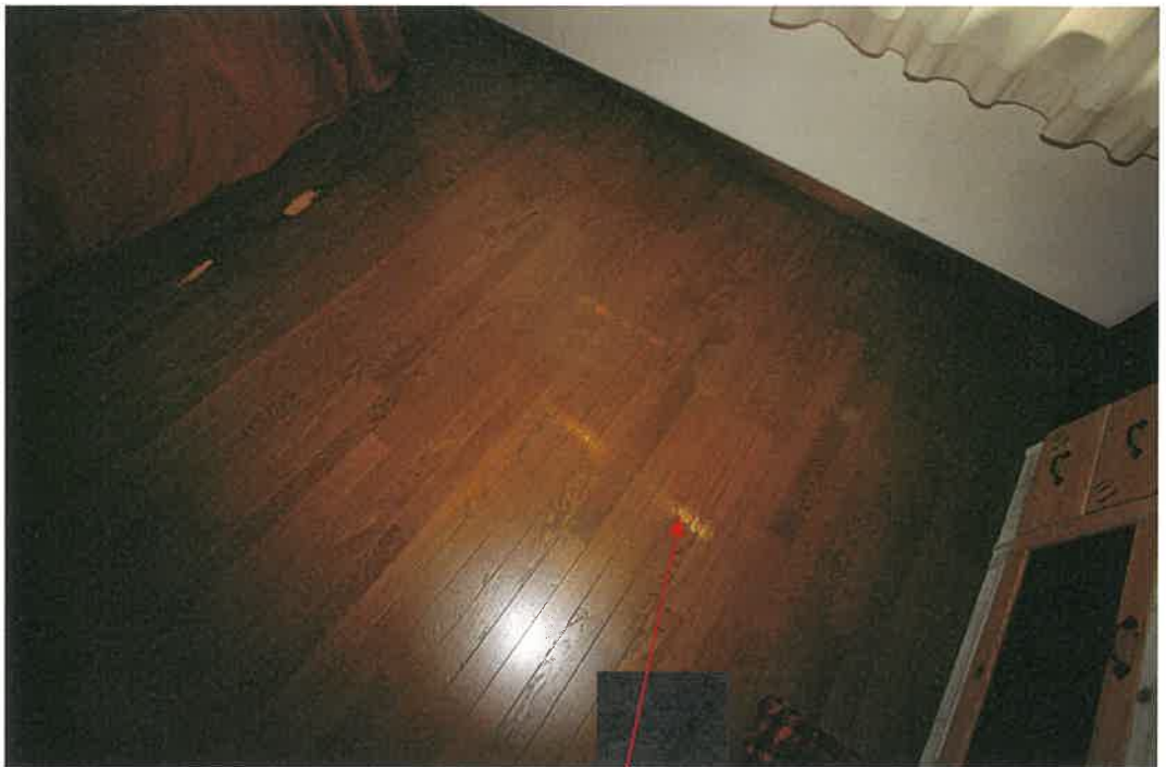
物件 2 建物 1 階室内 フローリングの傷
