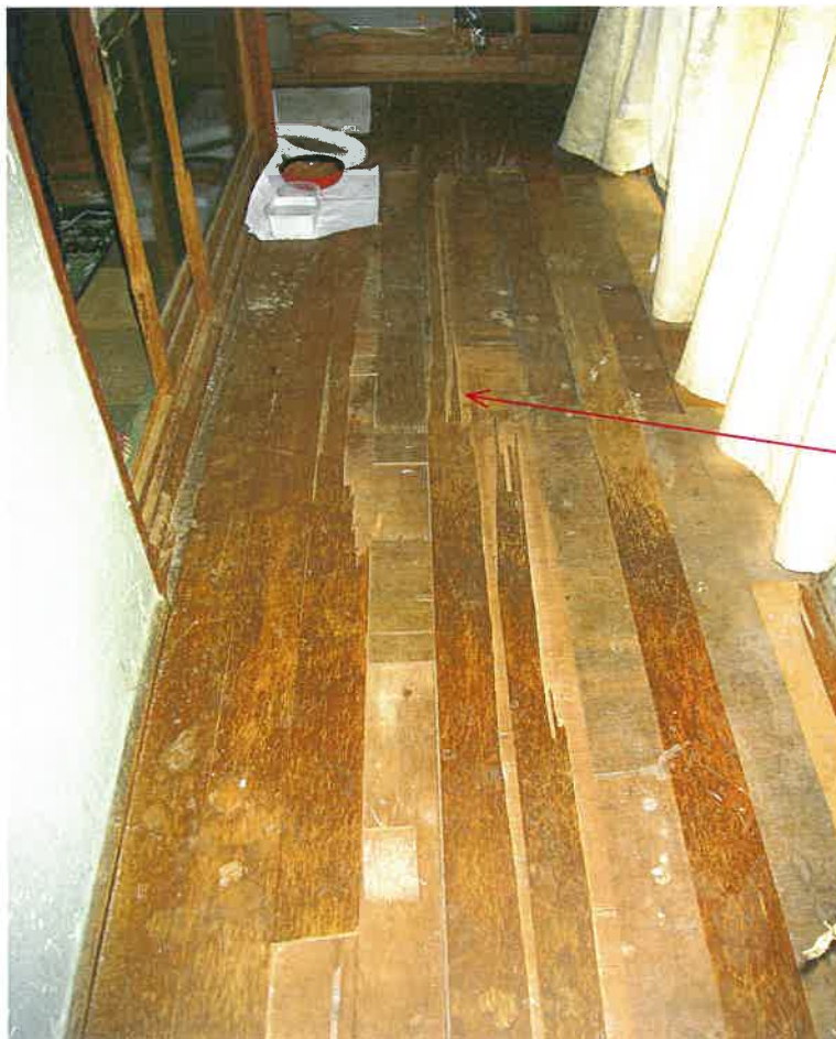
前同建物の廊下（広縁） の不安定箇所
