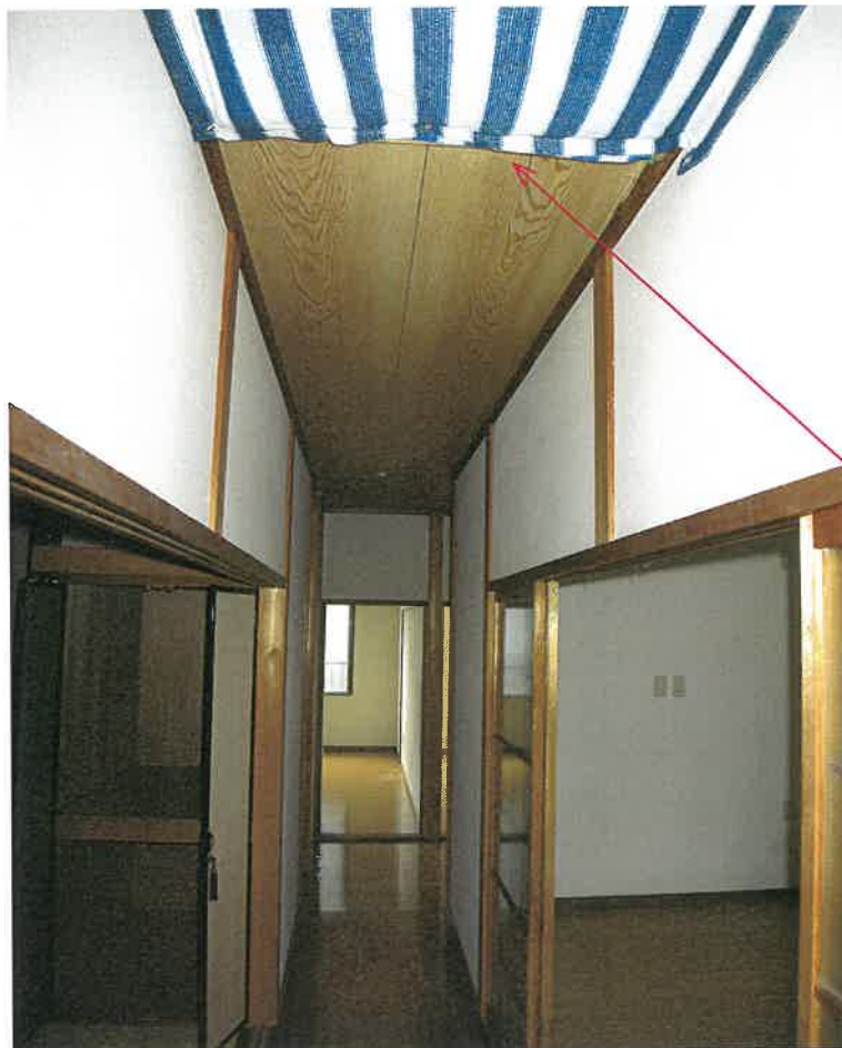
前同建物の2階廊下 (雨漏り箇所)
