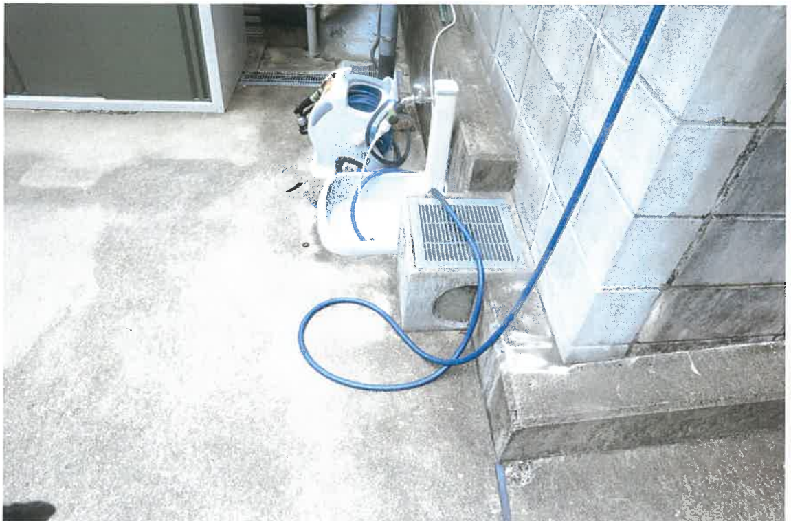
写真 3 2 物件 1 土地の概ね南西側隣地上に越境しているものと思料する雨水枡の状況
