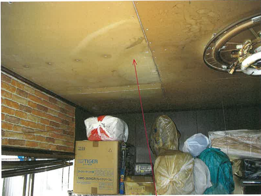
前同建物の室内（雨漏り箇所）
