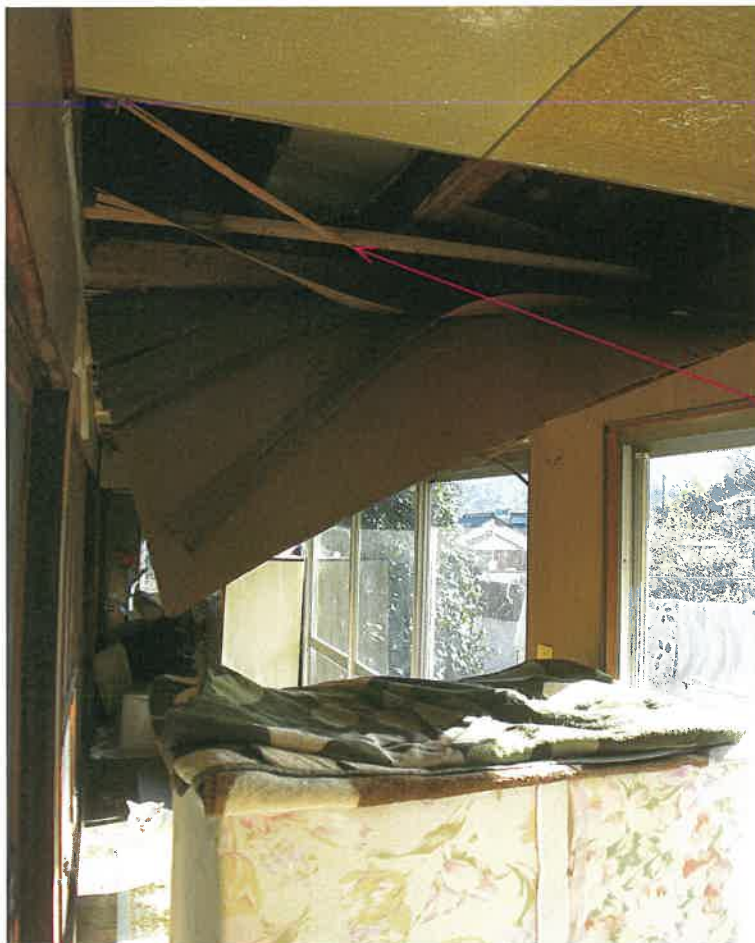
前同建物の縁側の 天井の損傷箇所
