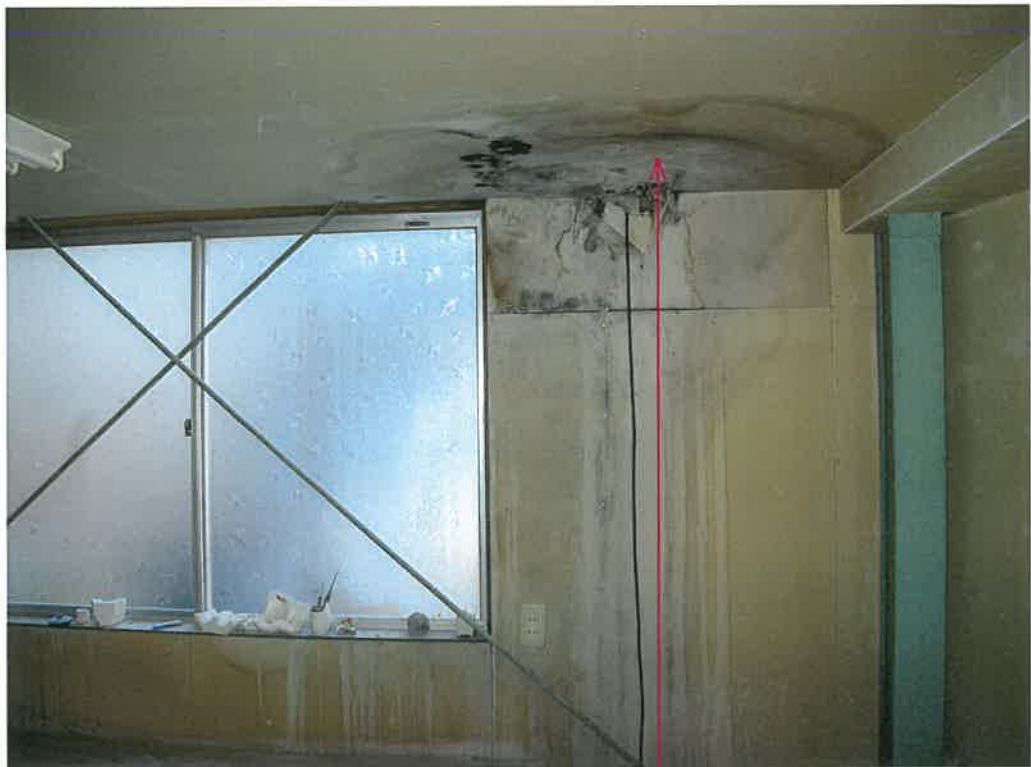
前同建物の作業場内（雨漏り箇所）
