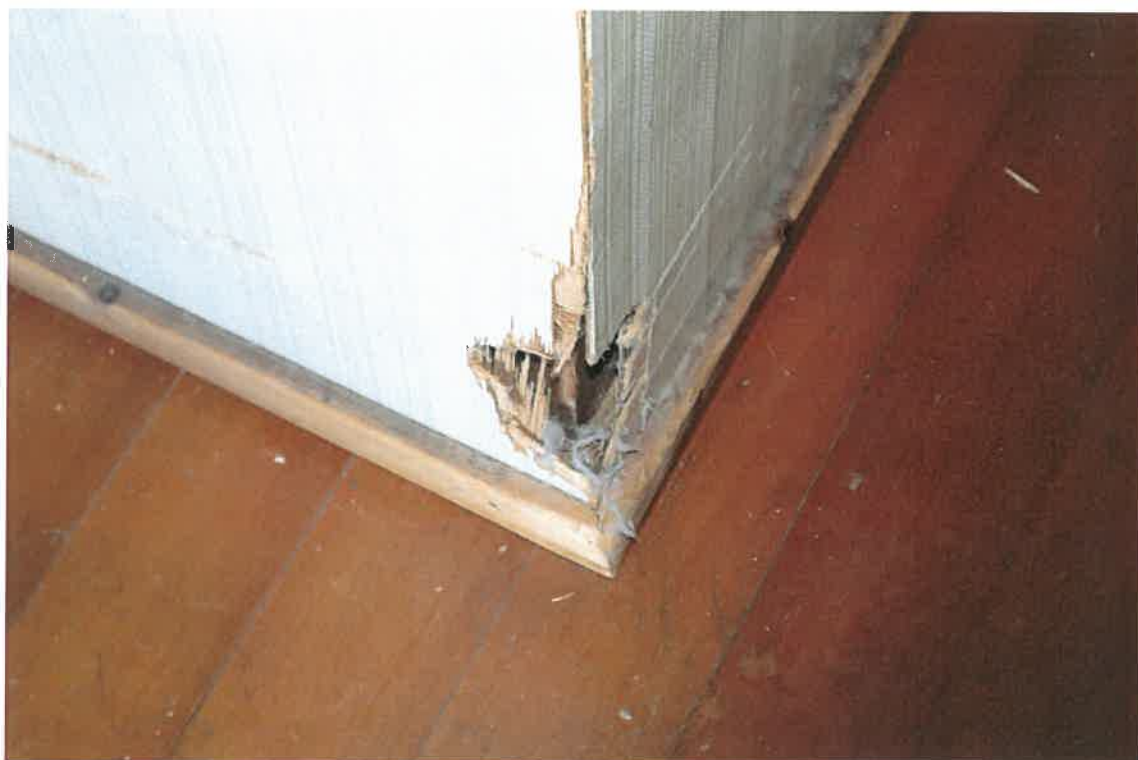
物件 7 附属建物 2 廊下の壁の損傷箇所
