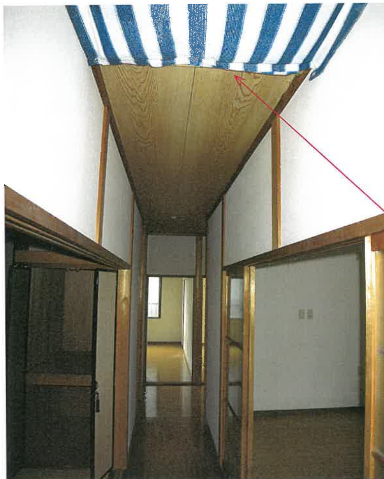
前同建物の2階廊下 (雨漏り箇所)
