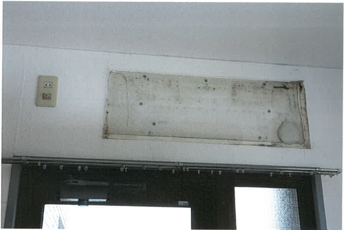
物件 2 建物 6 0 6 号室内の損傷箇所
