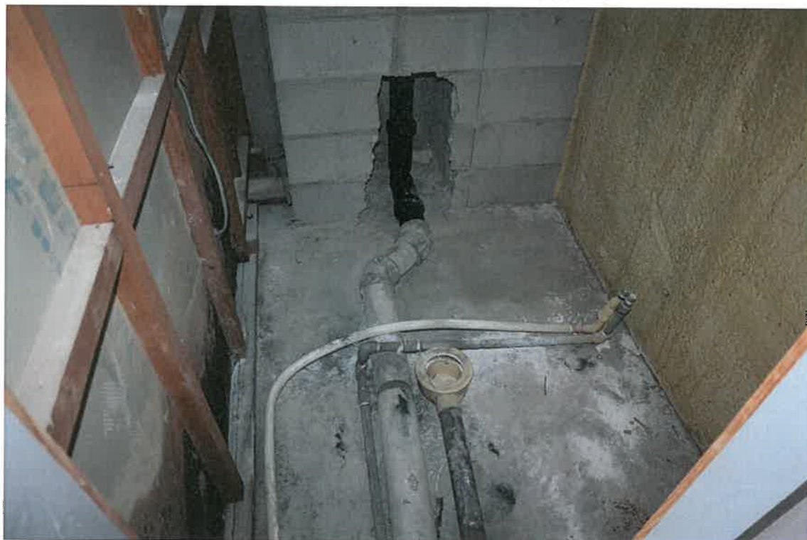
物件 2 建物 3 0 5 号室内の損傷箇所
