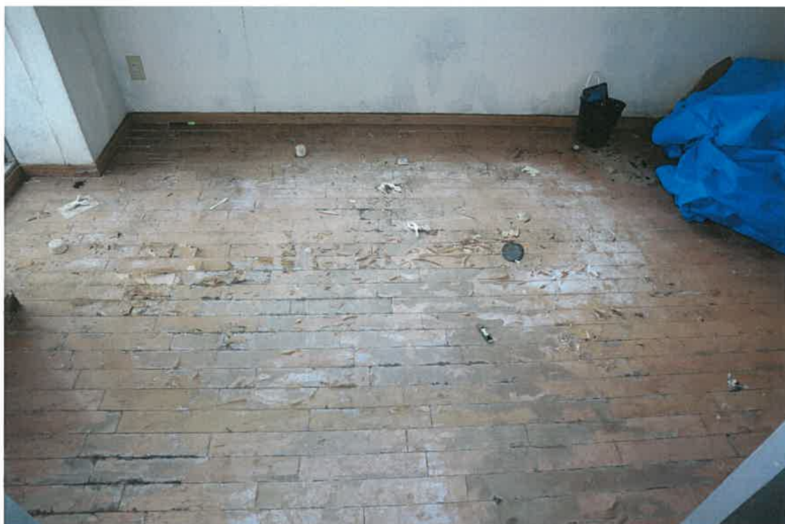
物件 2 建物 2 0 5 号室内の損傷箇所
