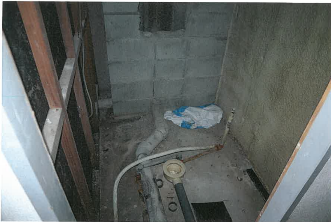
物件 2 建物 2 0 5 号室内の損傷箇所
