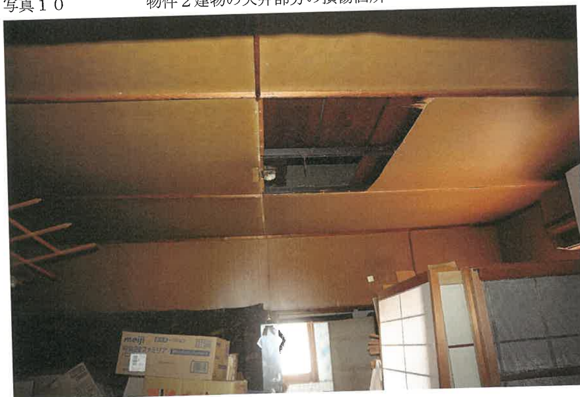
物件 2 建物の天井部分の損傷箇所
