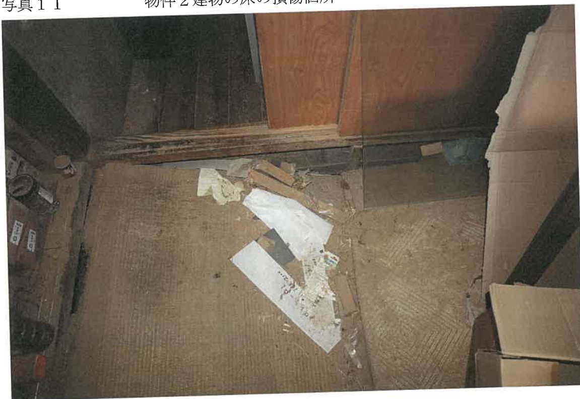
物件 2 建物の床の損傷箇所
