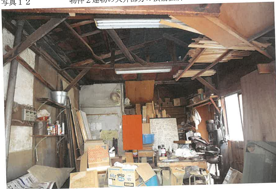
物件 2 建物の天井部分の損傷箇所
