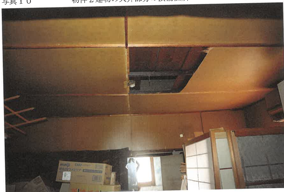
物件2建物の天井部分の損傷箇所
