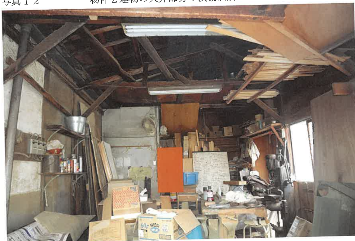
物件 2 建物の天井部分の損傷箇所
