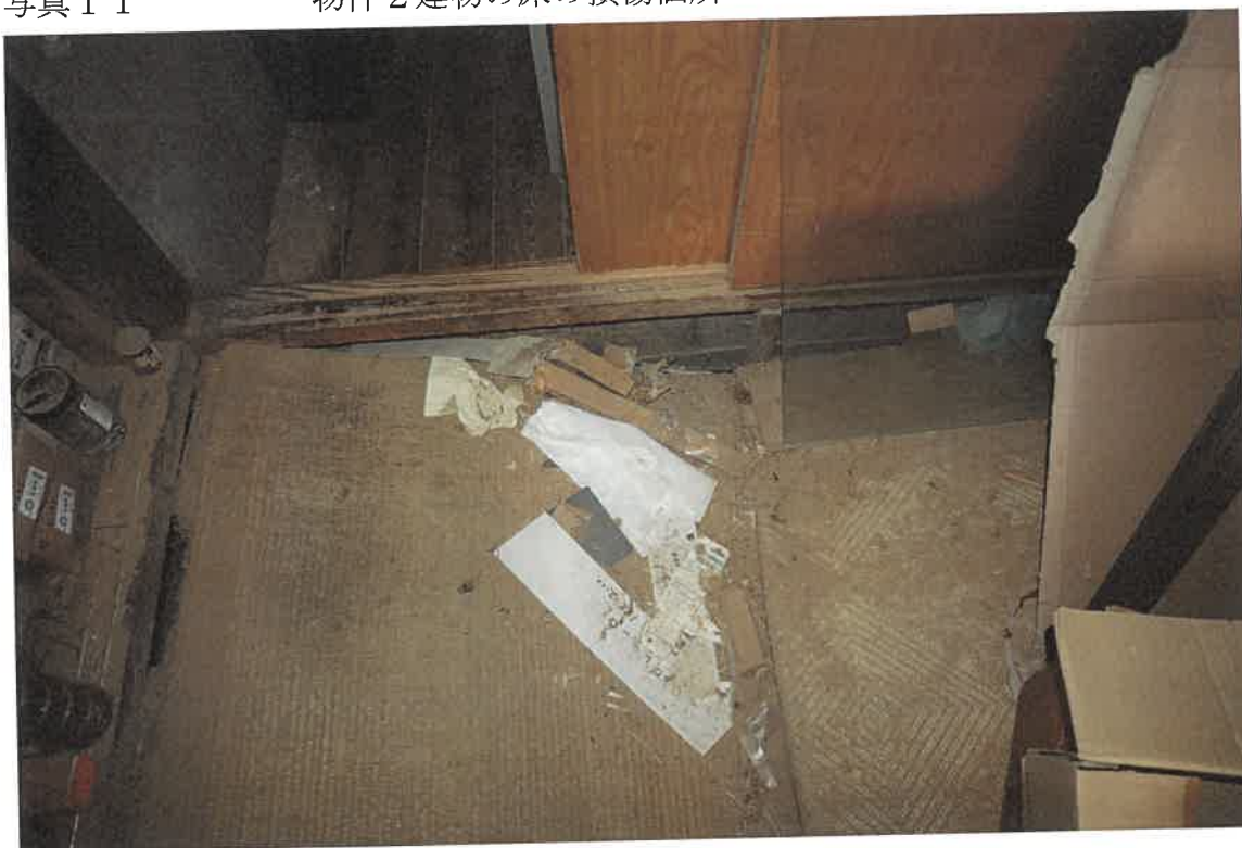
物件 2 建物の床の損傷箇所
