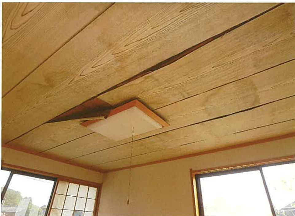
天井の損傷状況
