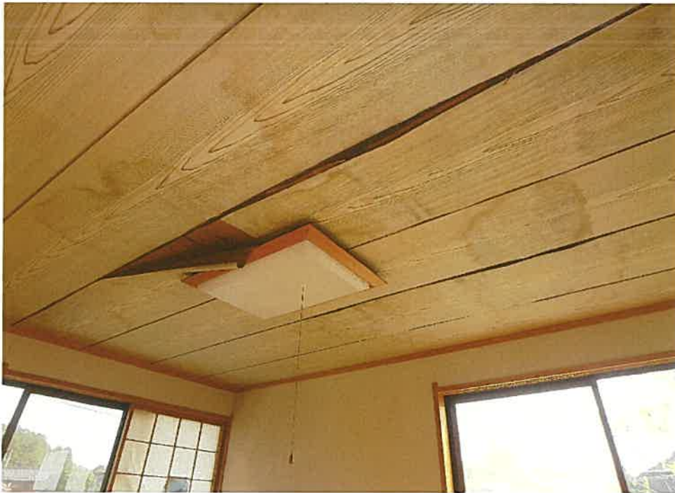
天井の損傷状況
