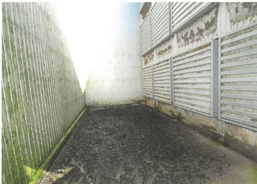
写真⑨ ダクトチャンバー
