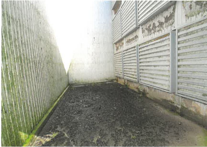
写真⑨ ダクトチャンバー
