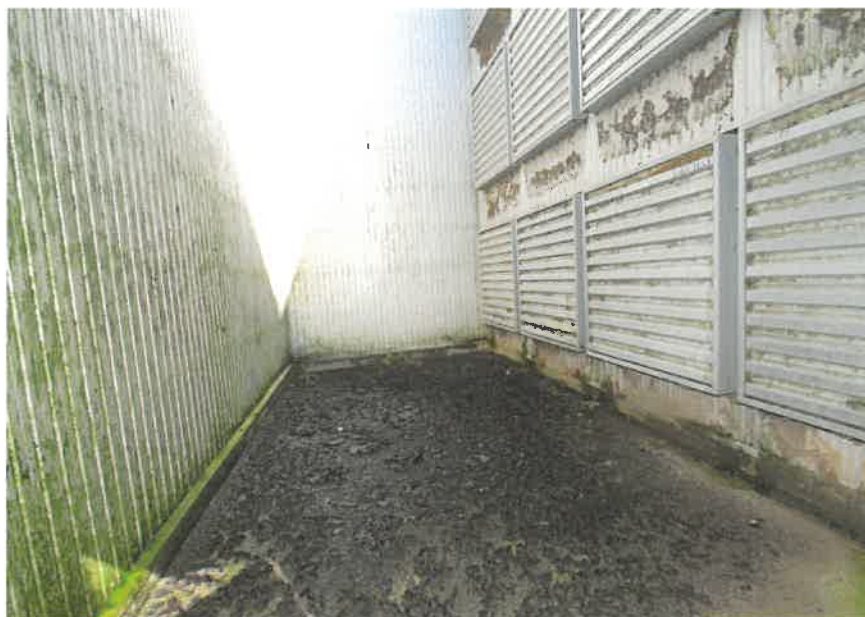
写真⑨ ダクトチャンバー
