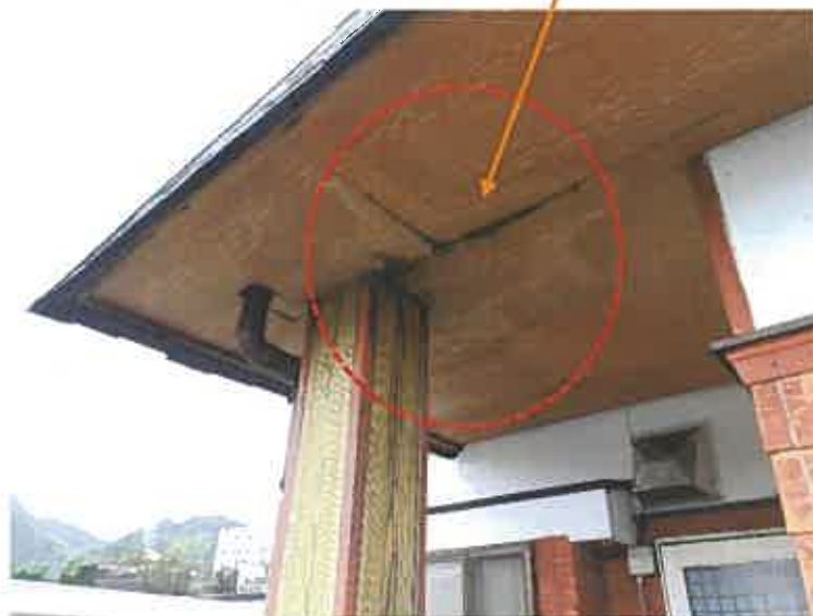
写真15 (本件建物 2階) 雨漏りしている旨述べた箇所
