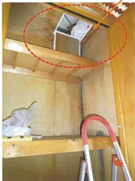
写真14 (本件建物 2階) 雨漏りしている旨述べた箇所
