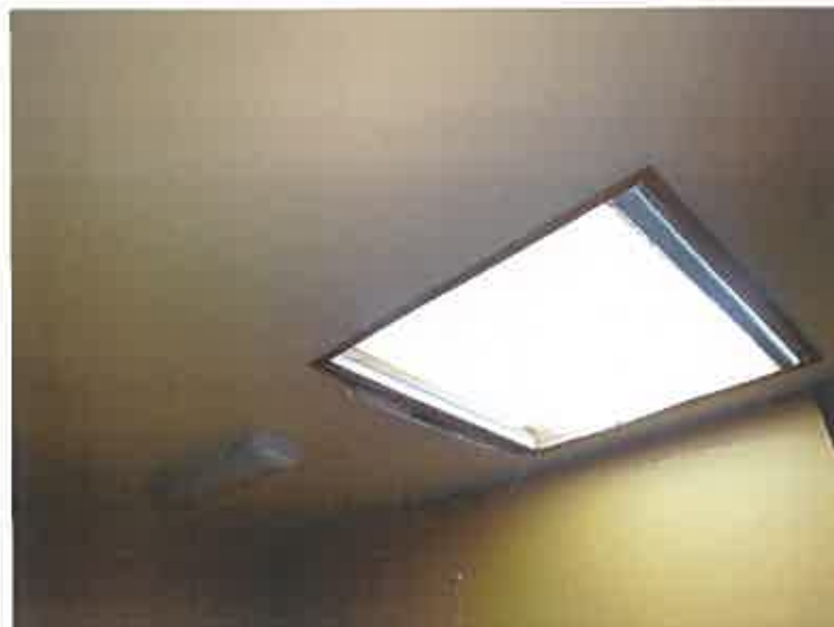
写真15 (本件建物 2階 (雨漏りがしている旨述べた天窗))
