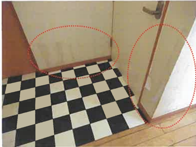
写真10 (本件建物 2階 (壁紙が傷んでいる箇所))
