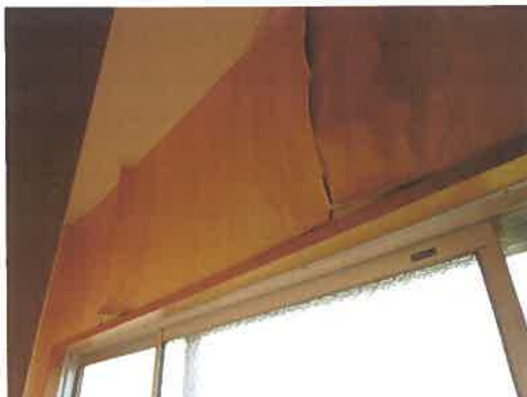
写真6 (本件建物 1階 (壁紙が傷んでいる状況))
