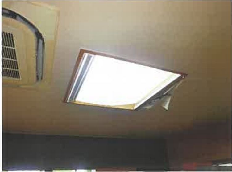
写真16 (本件建物 2階 (雨漏りがしている旨述べた天窗))
