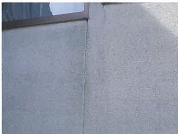
写真5 外壁のクラック
