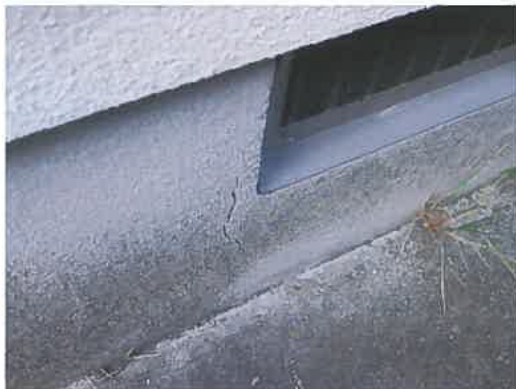
写真4 基礎のクラック
