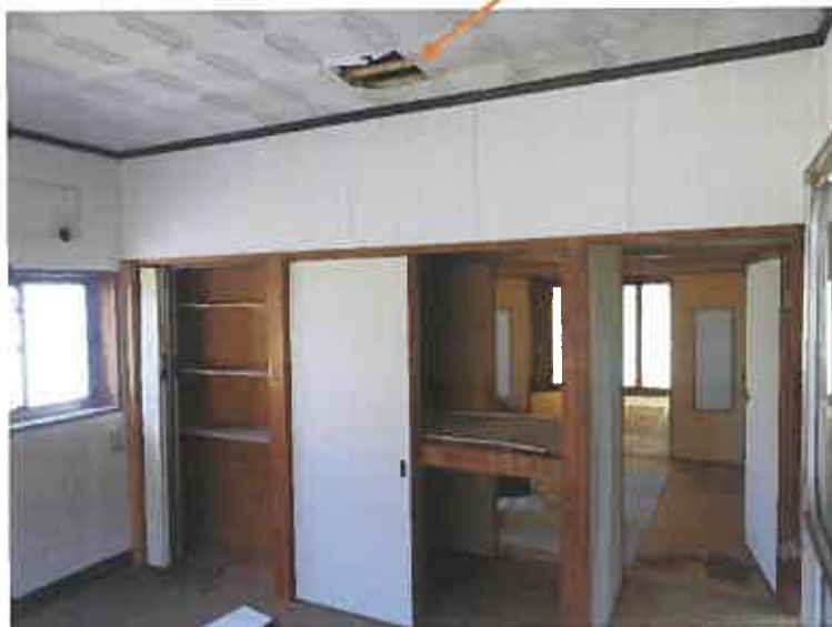
写真21 (物件2の建物 3階) 穴が空いている箇所
