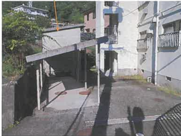
写真4 附属建物符号1 (機械室)
