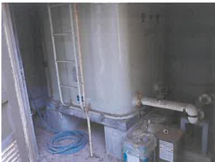
写真6 附属建物符号1 (機械室)
