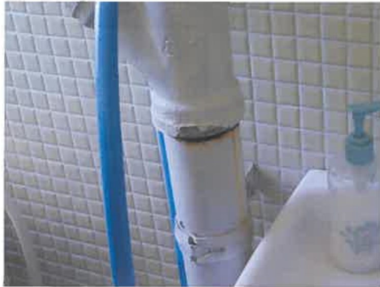
写真55 401号室（配管の外れ）
