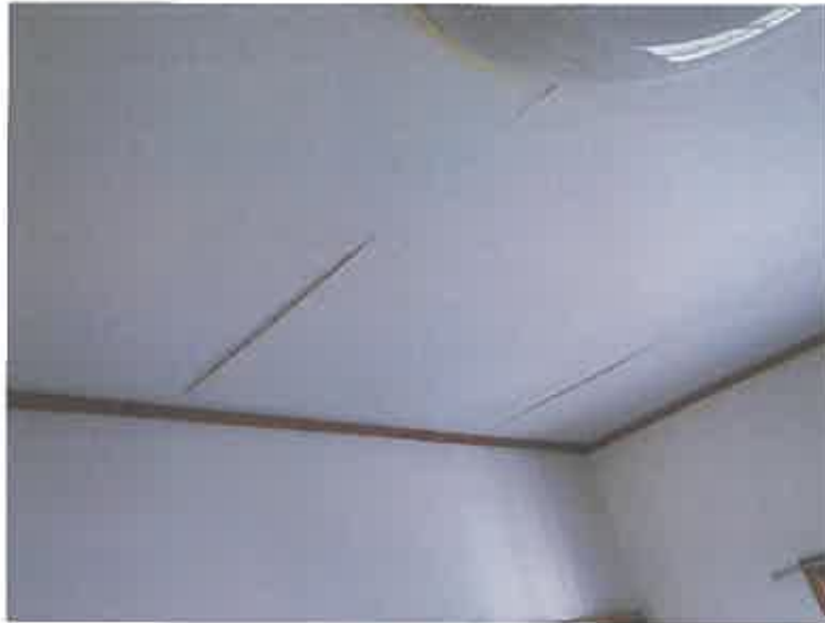
写真58 401号室 (クロスの剥離)
