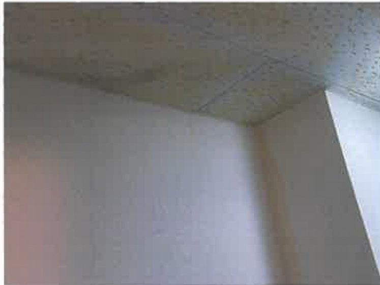
写真14 202号室（漏水があった箇所）
