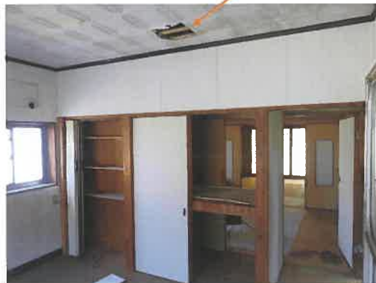
写真21 (物件2の建物 3階) 穴が空いている箇所
