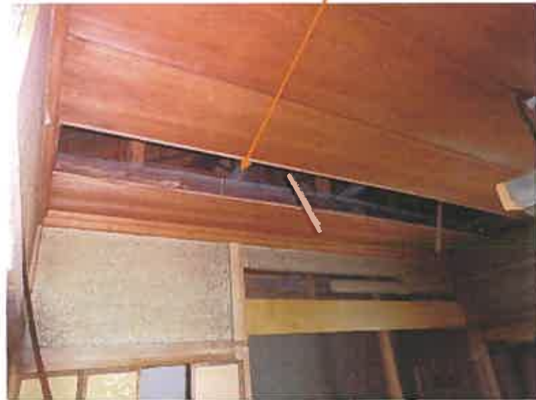
写真38 (物件3の建物 2階) 天井板が外れている箇所
