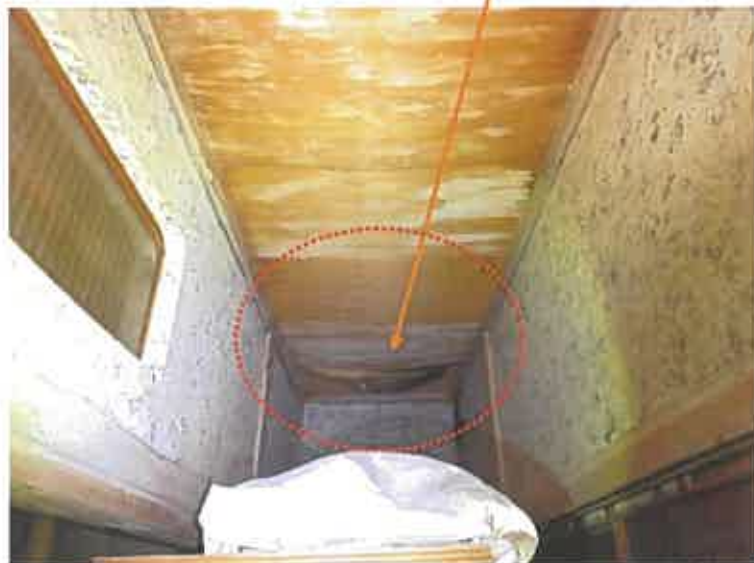
写真39 (物件3の建物 2階) 雨漏りがしていると思われる箇所
