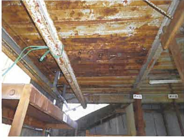
写真16 (物件2の建物 2階 (天井板が錆びている状況))
